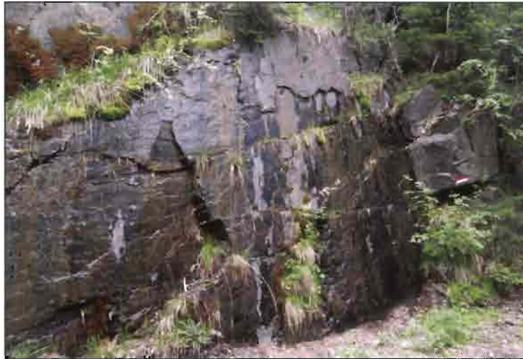
Fig. 15-72 Particolare di un piano di frattura sub-verticale.
