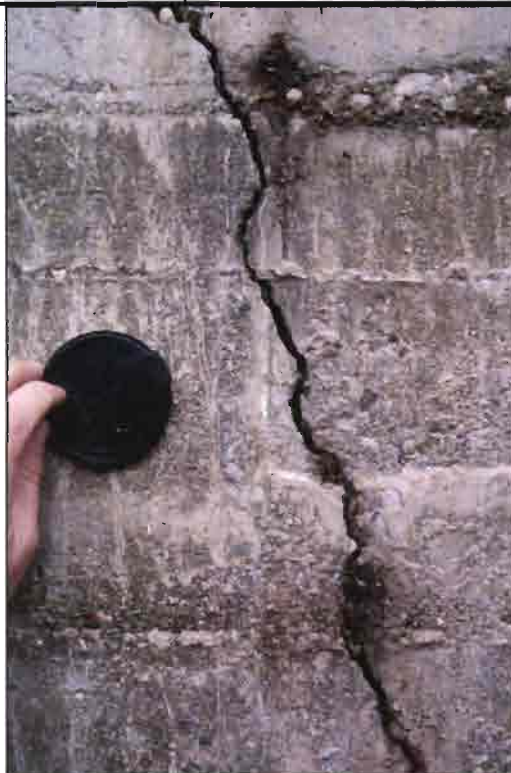
Fig. 15-21 Frattura all'interno di un muro di contenimento.
