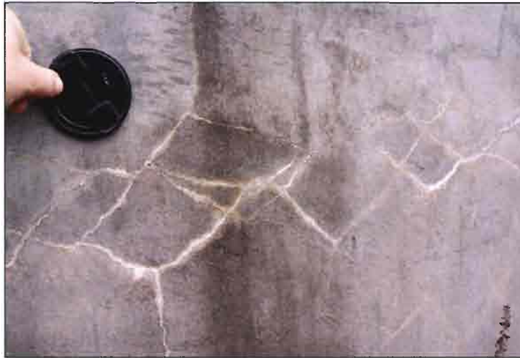
Fig. 5-26 Particolare delle fratture sul muro di sostegno.
