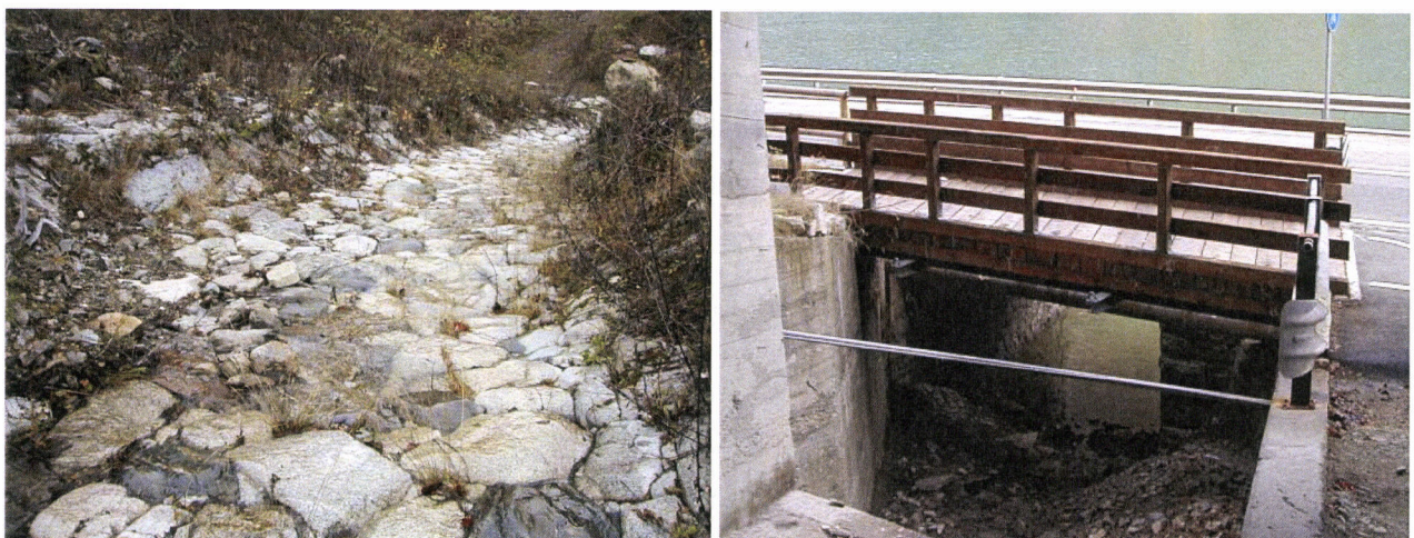
Figura 7 – Cunetta in massi ciclopici a secco (a sinistra), ponte in legno (a destra).
