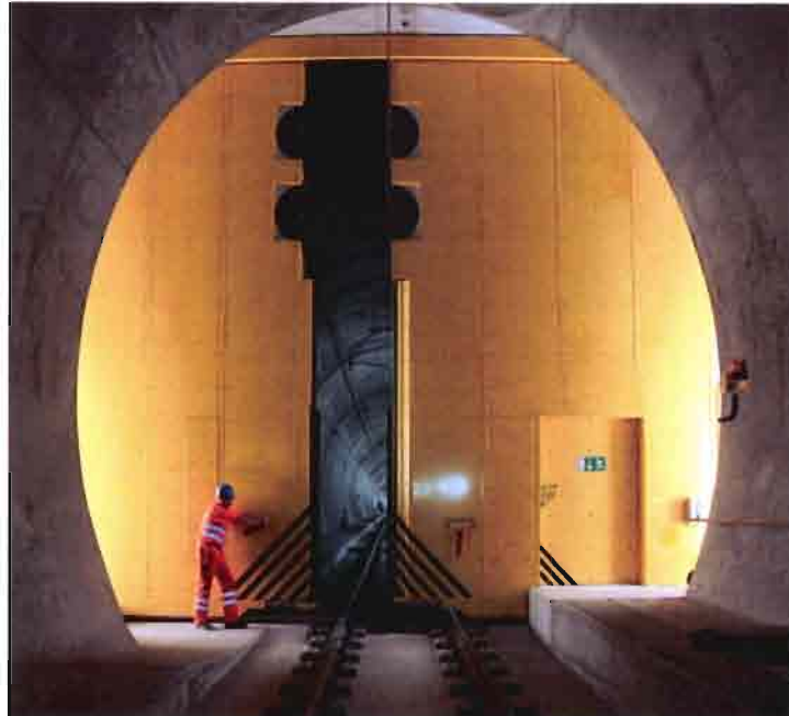
Figura 33 - Porte scorrevoli disconnessione fumi (Galleria Lötschberg)
