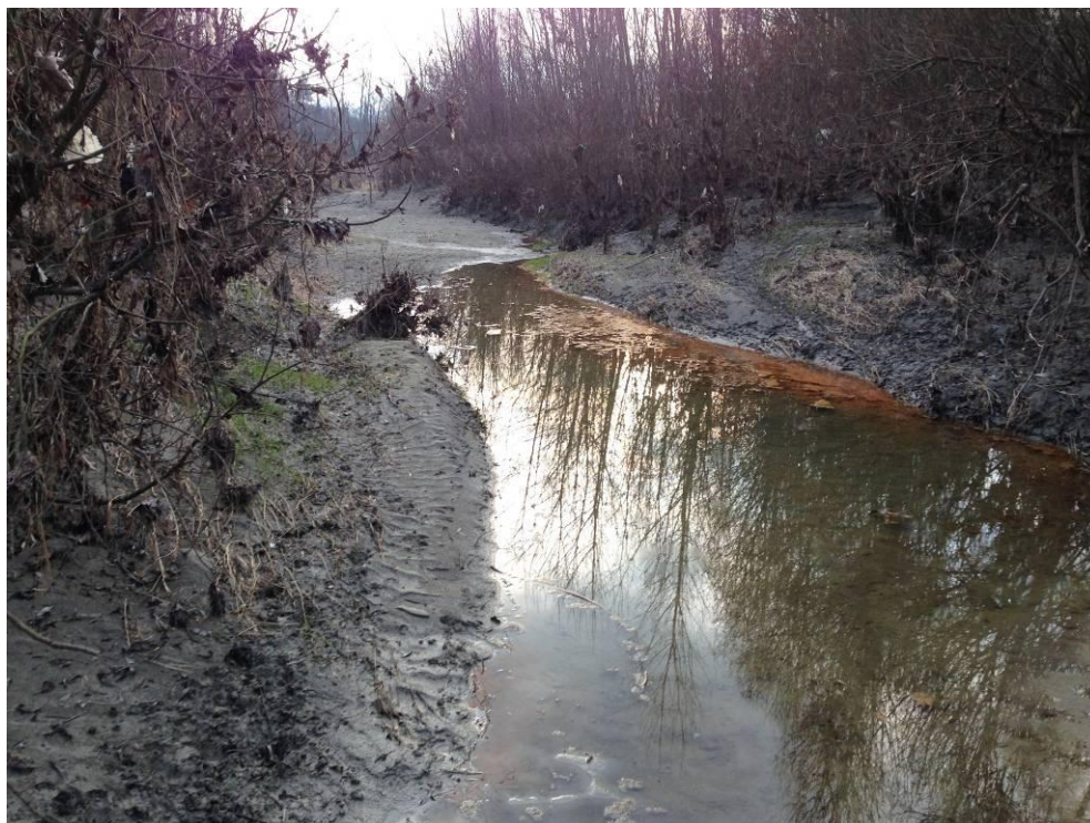
foto 11: vista da monte verso valle del canale esistente in sponda sinistra che si prevede di utilizzare, dopo un opportuno adeguamento della sezione idraulica, come canale di scarico.
