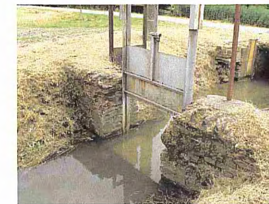
MANUFATTO M40 - PARATOIA NORD
