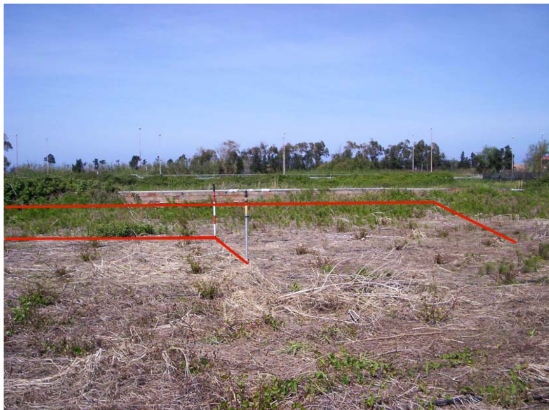
Foto 01: Panoramica dei punti iniziali delle condotte
