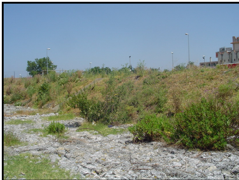
Foto 4.3.2-C – Gabbioni in pietrame e rete elettrosaldata , nell'area di raccordo tra l'argine in cemento e il successivo argine in terra.
