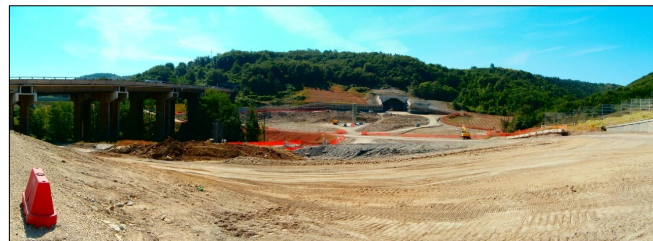
Figura 5: foto panoramica relativa all'area d'intervento (presa dal futuro piazzale "conci") nel suo stato attuale ad oggi
