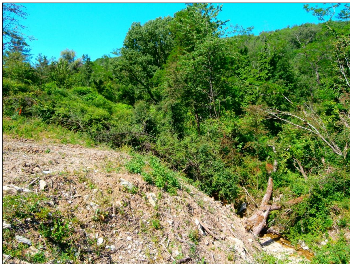
Figura 26: foto Fosso Baccheraia nel tratto a monte rispetto al cantiere – Particolare del muro di vegetazione a monte del tratto interessato dalle lavorazioni
