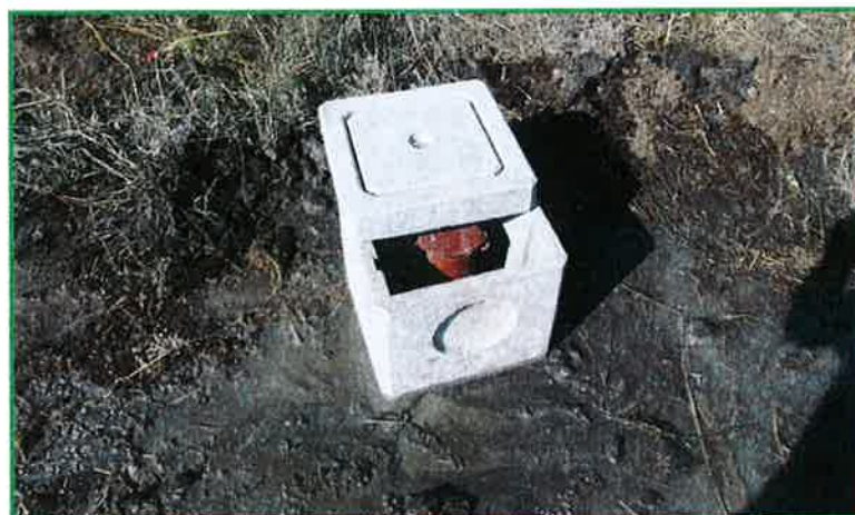
Sondaggio S1: Pozzetto di protezione piezometro con chiusino
