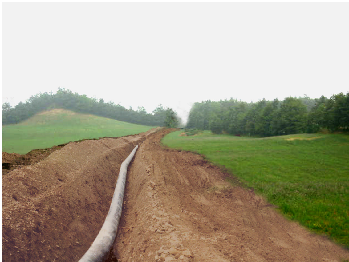
Fig. 4.1/H: Ritombamento della trincea
