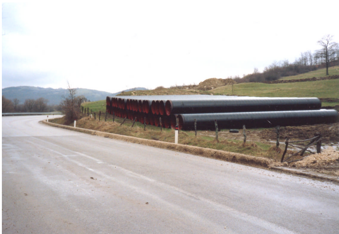
Fig. 5.1/A Piazzola di accatastamento tubazioni
