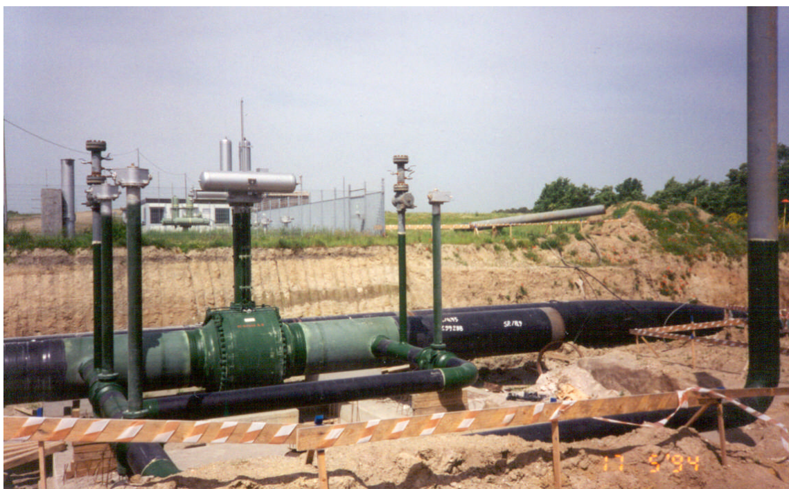
Foto 5.1/N Impianto di intercettazione di linea (PIL)
