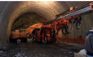
Grave incidente in un cantiere del Terzo valico
