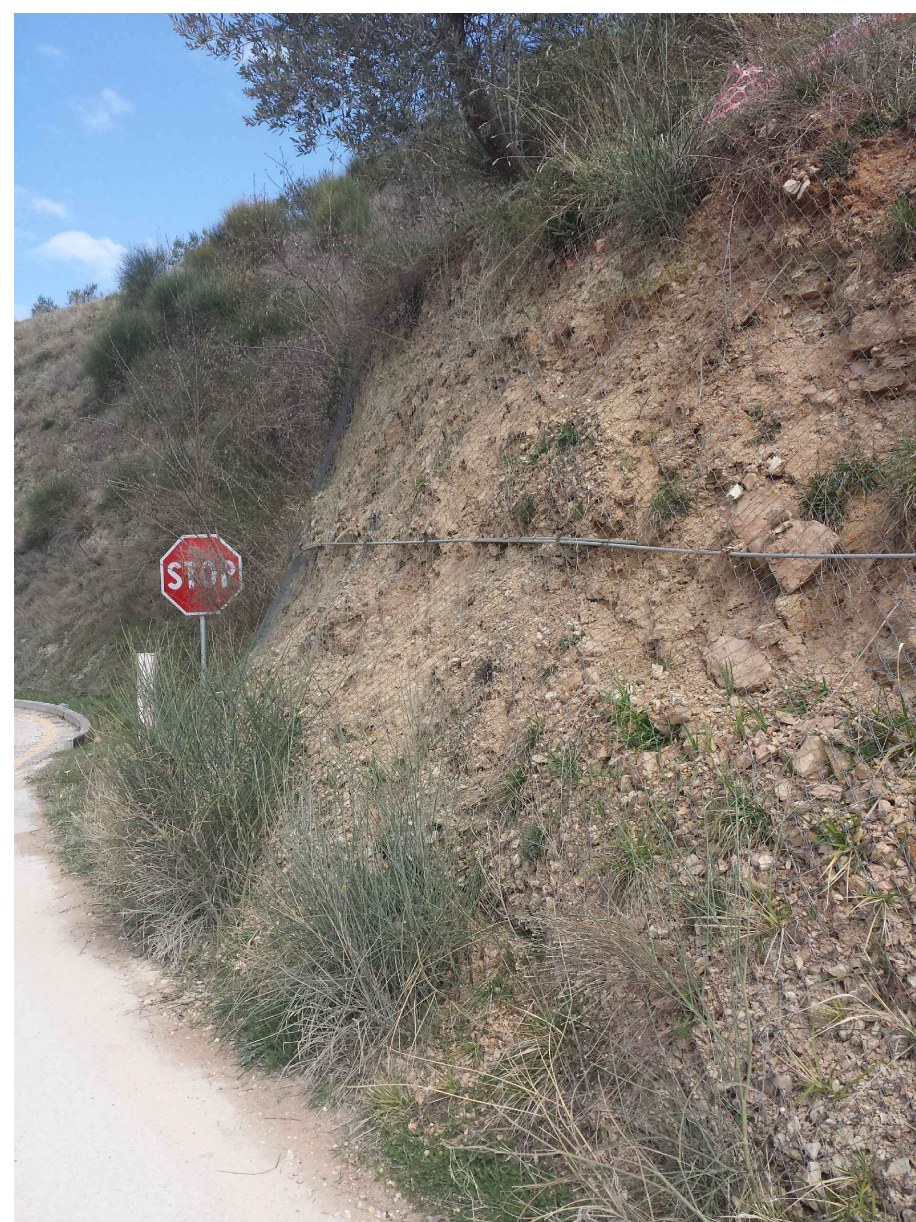
FOTO 1: Vista parete rivestita con rete paramassi in prossimità del collegamento tra via Altolina e la strada di cantiere esistente
