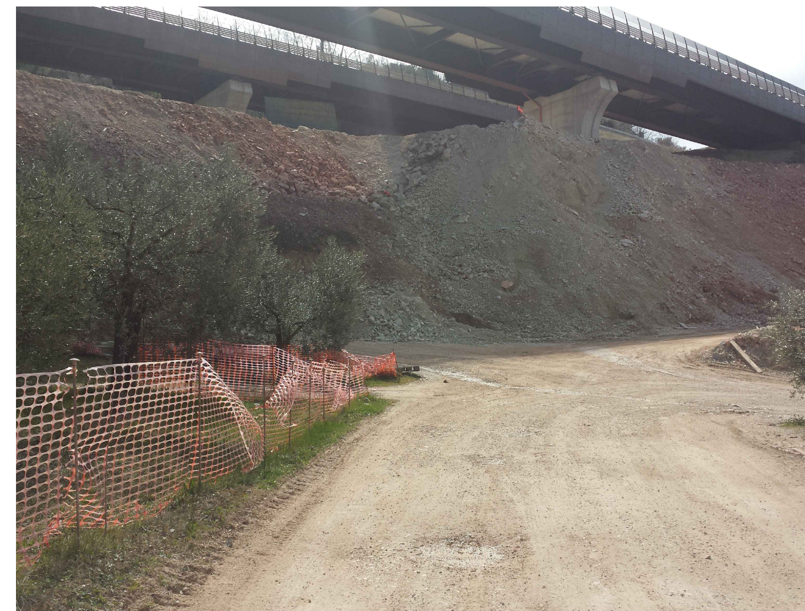
FOTO 3: Vista del tratto finale della strada di cantiere esistente in direzione del nuovo asse viario
