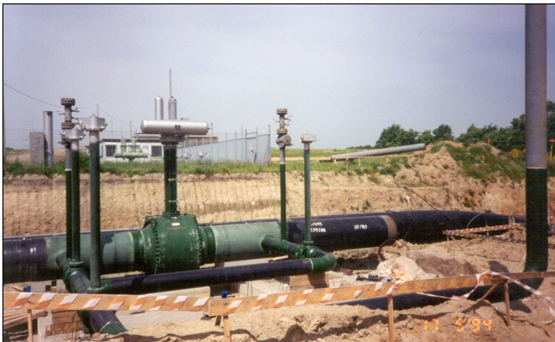
Foto 5.1/M: Punto di intercettazione di linea (PIL)
