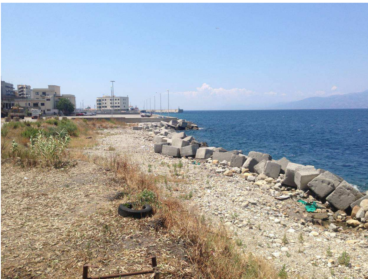
Figura 26 – Panoramiche dell'area costiera interessata d'intervento in cui si può notare l'eccessivo stato di degrado
