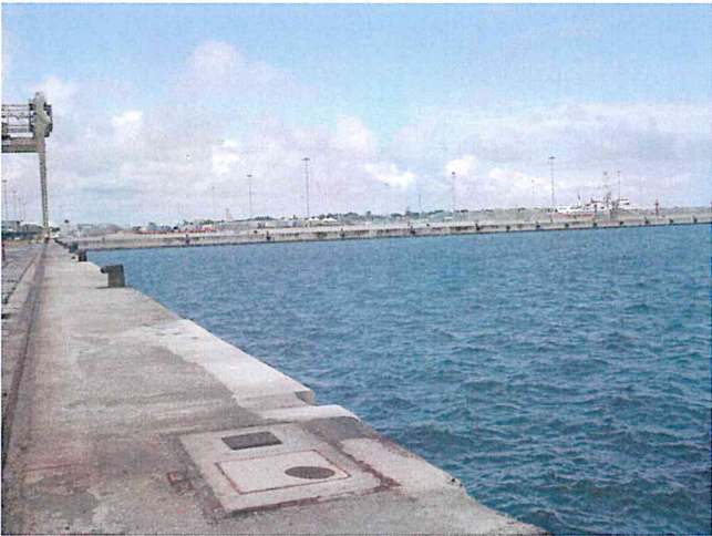
Pozzetto di arrivo del terminale
