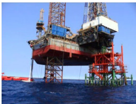
Fig. 1.1 - Settembre 2007. Jacket della piattaforma Tea e jack-up per i lavori di installazione e perforazione.
