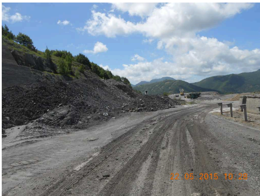
Figura 3: Ritombamento costone imbocco sud galleria Serra Rotonda – area critica 2
