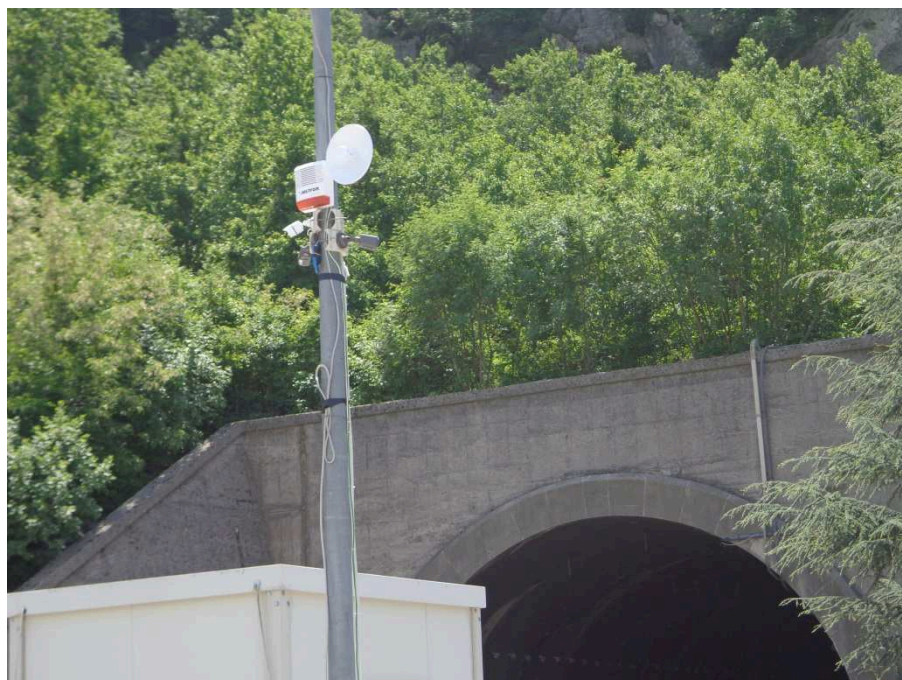
Figura 2: Sistema di videosorveglianza vecchia galleria Serra Rotonda imb. nord – area critica 1
