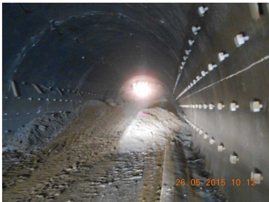
Figura 1: Ritombamento vecchia galleria Serra Rotonda – area critica 1
