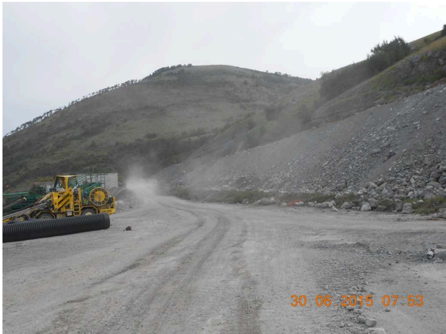
Figura 2: Ritombamento costone imbocco sud galleria Serra Rotonda – area critica 2
