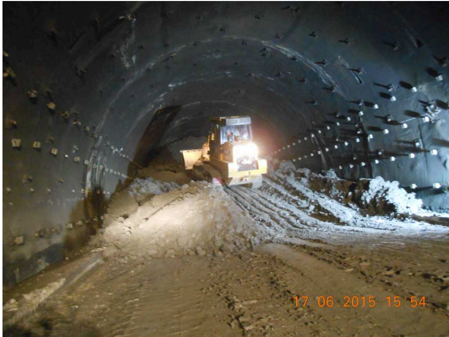
Figura 1: Ritombamento vecchia galleria Serra Rotonda – area critica 1
