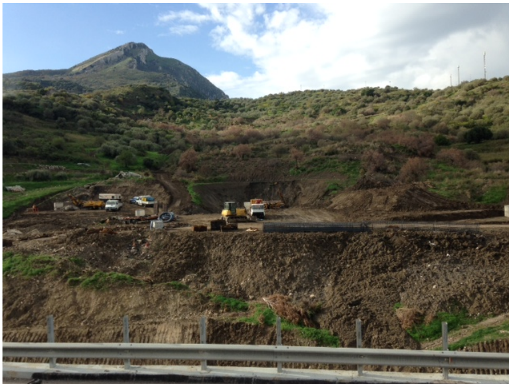
Area del versante sud, interessata dai lavori di decostruzione delle campate del viadotto Imera I tra le pile 16-22 della carreggiata direzione Catania
