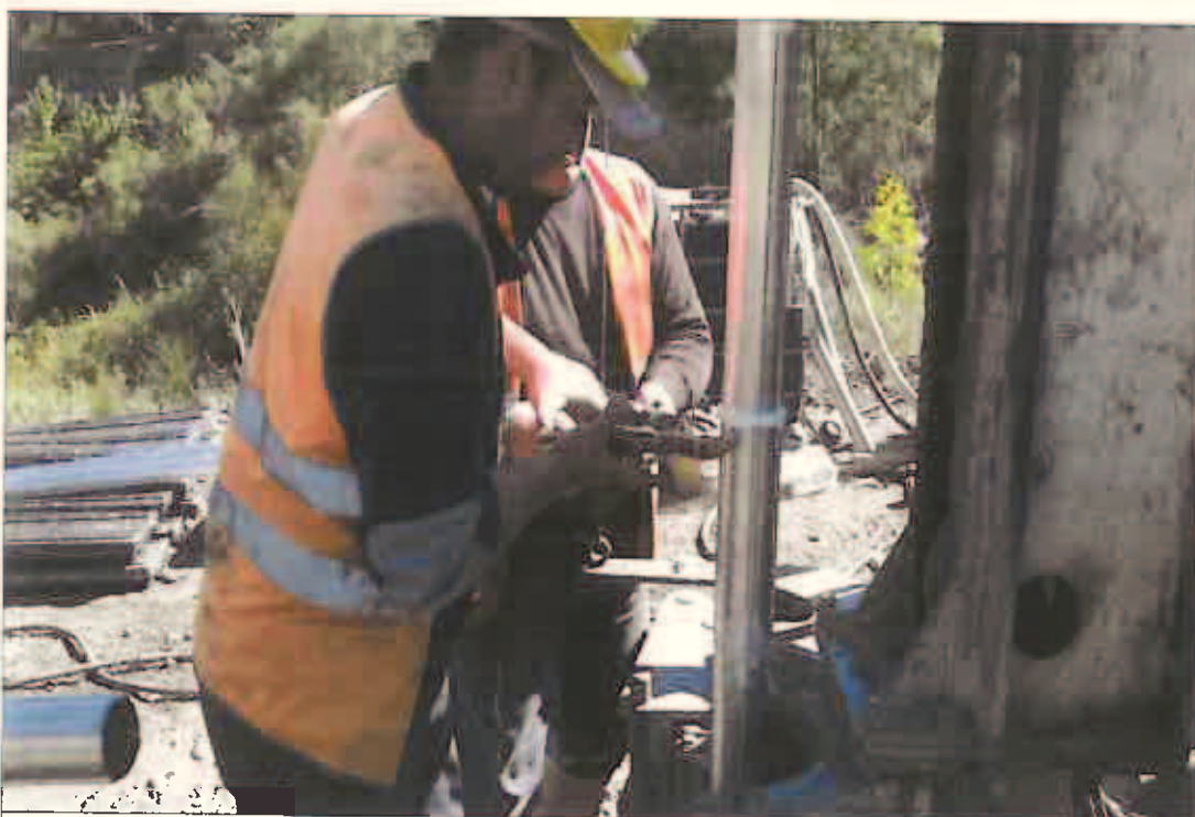
S2-Installazione Inclino metro
