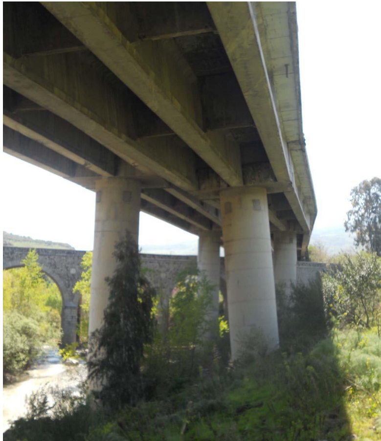
Figura 4 – Dissesto delle pile del viadotto.
