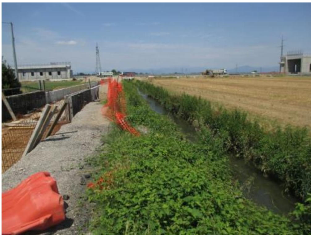
Figura 5.1 Nella prima foto è mostrata la roggia Brambilla in asciutta (monte) mentre nella seconda si possono notare le lavorazioni all'interno dell'alveo della Roggia Rondanino e conseguente deviazione delle sue acque all'interno delle Roggia Brambilla
