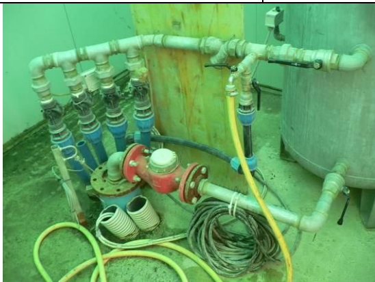
Punto AV-CA-SO-1-35. Impianto di pompaggio
