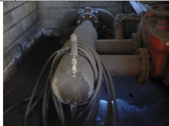
Punto AV-RD-SO-1-28. Impianto di pompaggio
