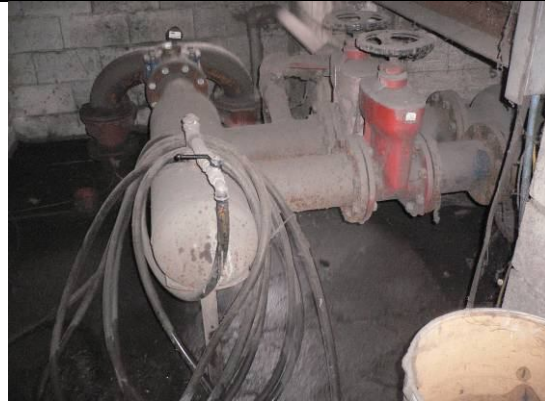
Punto AV-RD-SO-1-28. Impianto di pompaggio
