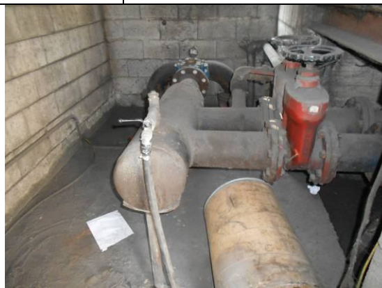
Punto AV-RD-SO-1-28. Impianto di pompaggio
