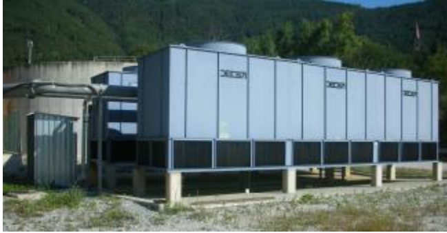
f) Rückkühlung / Raffreddamento
