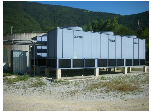
Rückkühlung zweisstrassig mit je drei Ventilatoren Raffreddamento a due vie con tre ventilatori ciascuna
