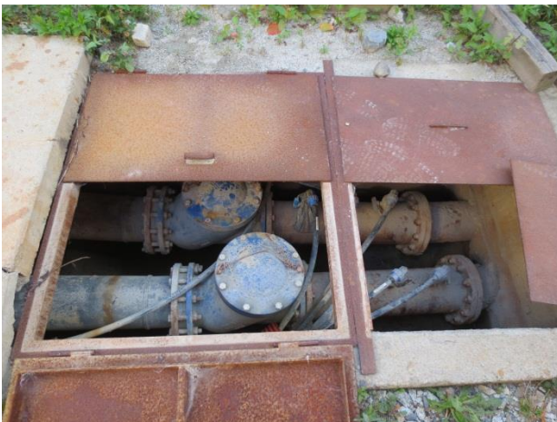
Zuleitung zu Hauptsedimentationen 1+2 mit Flockmittelbeimischung Condotta di convogliamento alle vasche 1+2 di sedimentazione primaria con aggiunta di flocculante
