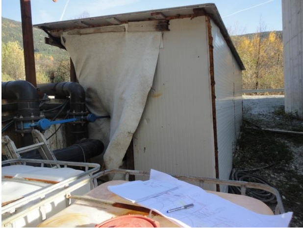
Notlagergebäude für Chemikalien (FeCl 3 ) Struttura di emergenza per agenti chimici (FeCl 3 )
