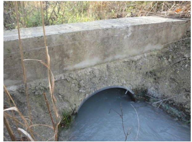
Durchlass bei Abwassermenge von ca. 100 l/s
