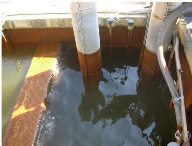
Ablauf Neutralisations- und Oxidationsbecken mit Tauchmotorpumpen zur Rückkühlung Scarico vasca di neutralizzazione e ossidazione con motopompe sommerse per il raffreddamento
