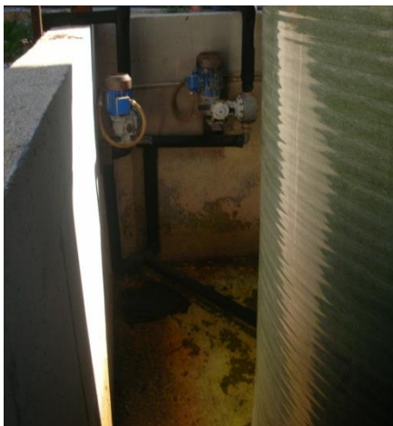
Dosierpumpen für Chemikalien ( \text{FeCl}_3 ) Pompe dosatrici per gli agenti chimici ( \text{FeCl}_3 )
