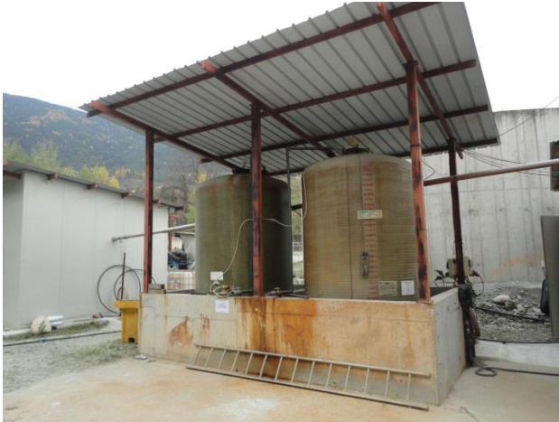
Lager für Flockmittel ( \text{FeCl}_3 ), Neutralisationsmittel ( \text{HCl} ) Deposito per il flocculante ( \text{FeCl}_3 ), agente neutralizzante ( \text{HCl} )
