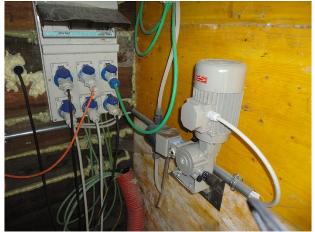
Elektrische Installationen bei der H 2 O 2 Dosierung Impianti elettrici nella struttura per il dosaggio dell'H 2 O 2
