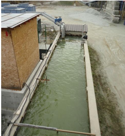
NaOCl Lagergebäude, Neutralisations/Oxidationsbecken Struttura per lo stoccaggio del NaOCl, vasca di neutralizzazione/ossidazione
