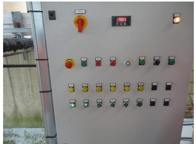
Zentrales Schalttableau für Steuerung Pannello elettrico centrale comandi
