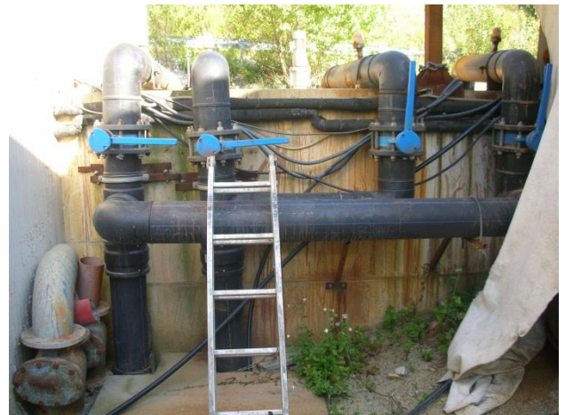
Pumpwerk zur Hauptsedimentation 1+2
