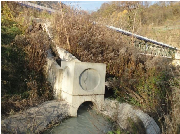
Abwasserzuleitung Portal Aica - Behandlungsanlage
