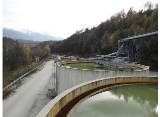
Hauptsedimentation 1+2 mit Räumsystem (Bodenschild) Vasche 1+2 di sedimentazione primaria con sistema di pulizia (lama raschiatrice)
