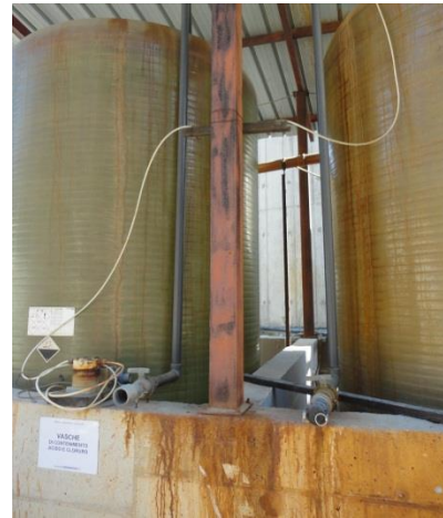
Chemikaliertanks und Auffangwanne (Beton) Serbatoio per gli agenti chimici e vasca di raccolta (calcestruzzo)
