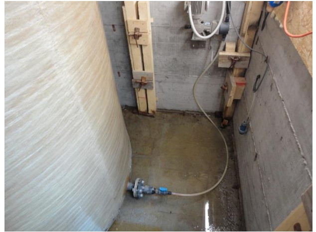
NaOCl-Lagertank und Dosierung Serbatoio per lo stoccaggio e il dosaggio di NaOCl
