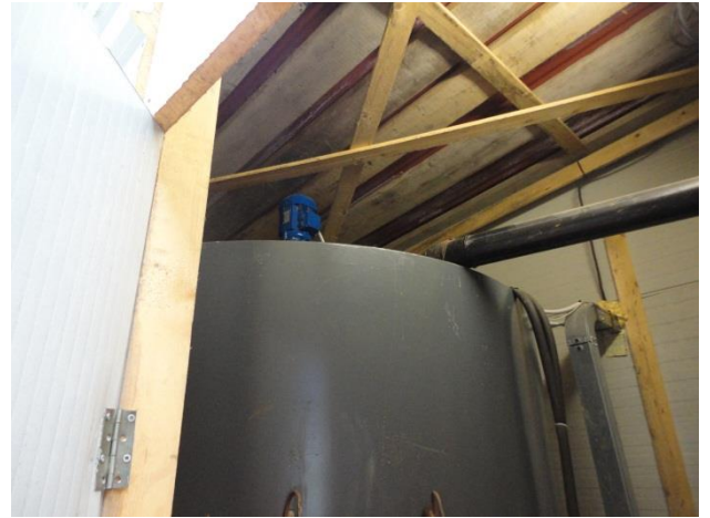
Schlammvorlagebehälter mit Rührwerk
