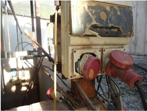
Elektrische Installationen beim Chemikalienlager Impianti elettrici nel deposito di agenti chimici
