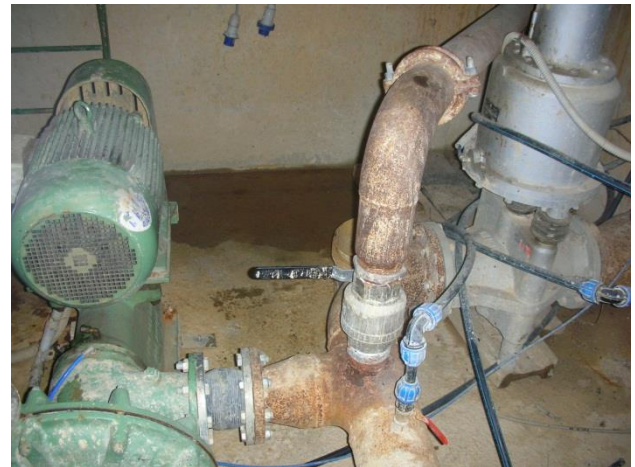
Pumpwerk Schlammernahme Hauptsedimentation 2 Stazione di pompaggio, estrazione dei fanghi, sedimentazione primaria 2
