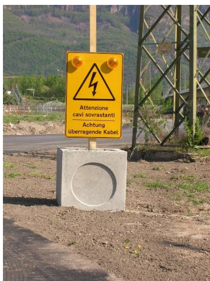
Abbildung 39: Baustelle Sachsenklemme – Warnschilder (Freileitungen)
