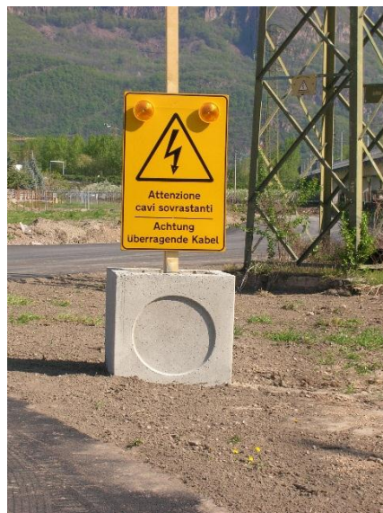
Figura 41: Cantiere di Hinterrigger– Segnaletica di pericolo delle linee elettriche aeree
