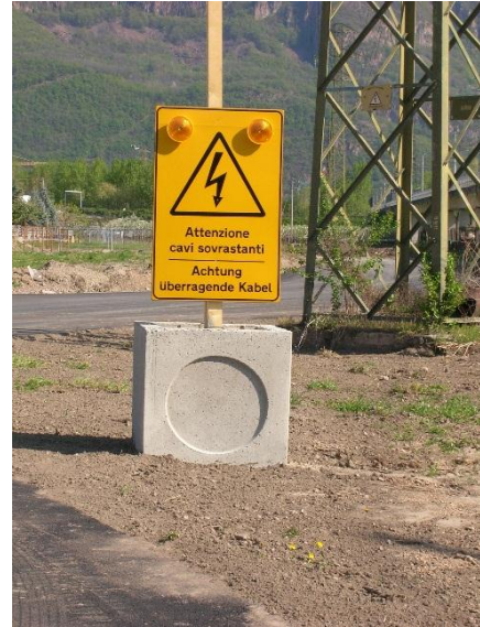
Figura 33: Cantiere di Muls – Segnaletica di pericolo delle linee elettriche aeree
