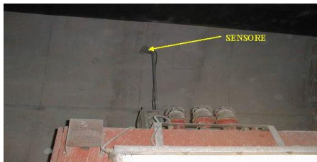
Abbildung 5: Erdgas- und Schwefelwasserstoffsensoren
