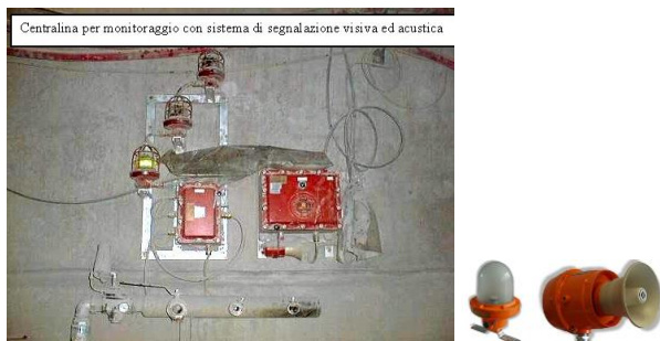
Abbildung 6: Steuerzentrale für die automatische Überwachung
