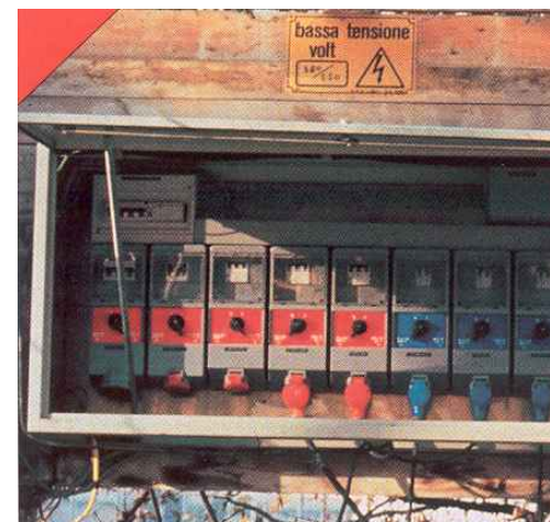
QUADRO ELETTRICO DI CANTIERE HAUPTSCHALTAFEL EINER BAUSTELLE.
