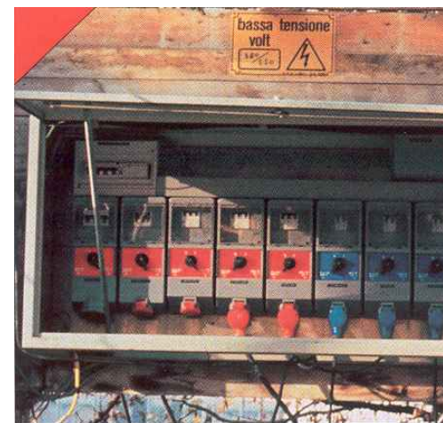
QUADRO ELETTRICO DI CANTIERE HAUPTSCHALTAFEL EINER BAUSTELLE.
