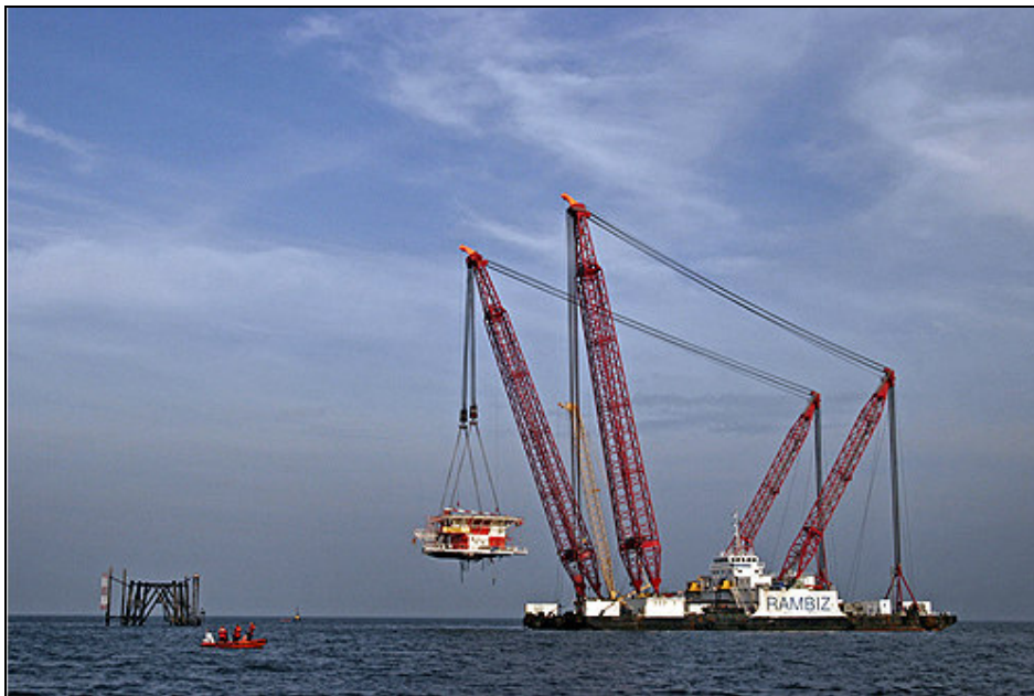
Figura 2.23: Sollevamento di un Deck
