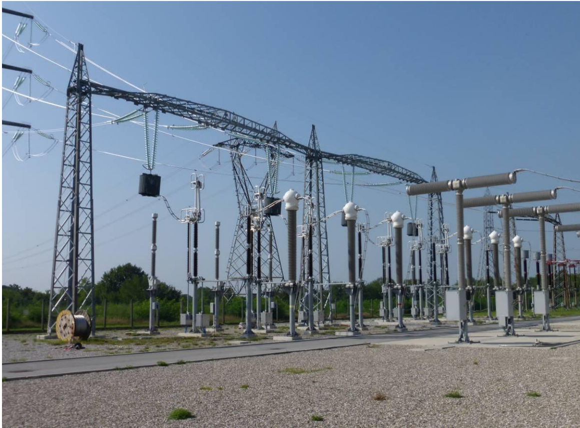
Foto 14 – Ingresso linea d.t. 380 kV "S.E. Udine Sud - S.E. Udine Ovest"
