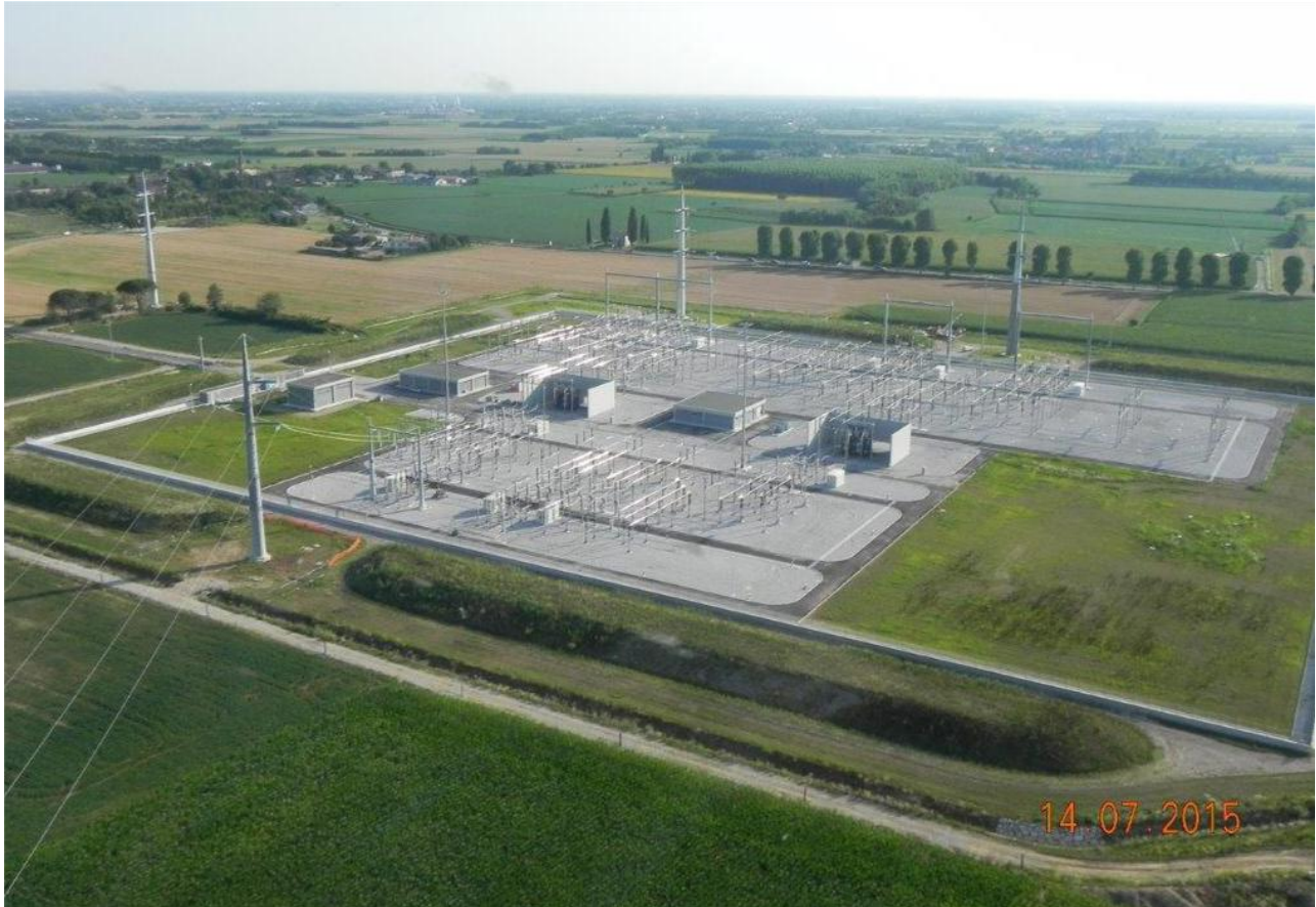
Foto 1 – Vista aerea della stazione elettrica 380/220 kV di Udine Sud (lato sezione 220 kV)
