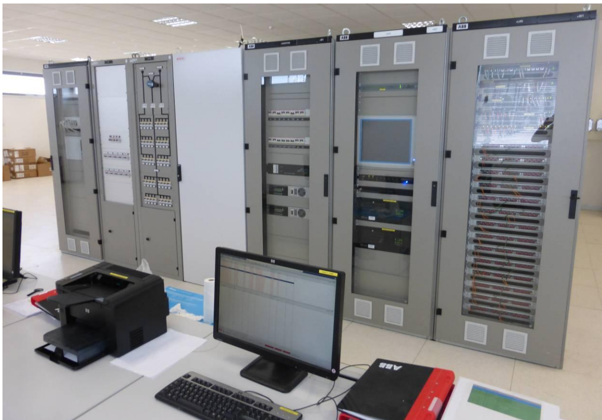
Foto 12 – Postazione HMI (interfaccia di comando interna all'edificio Comandi)
