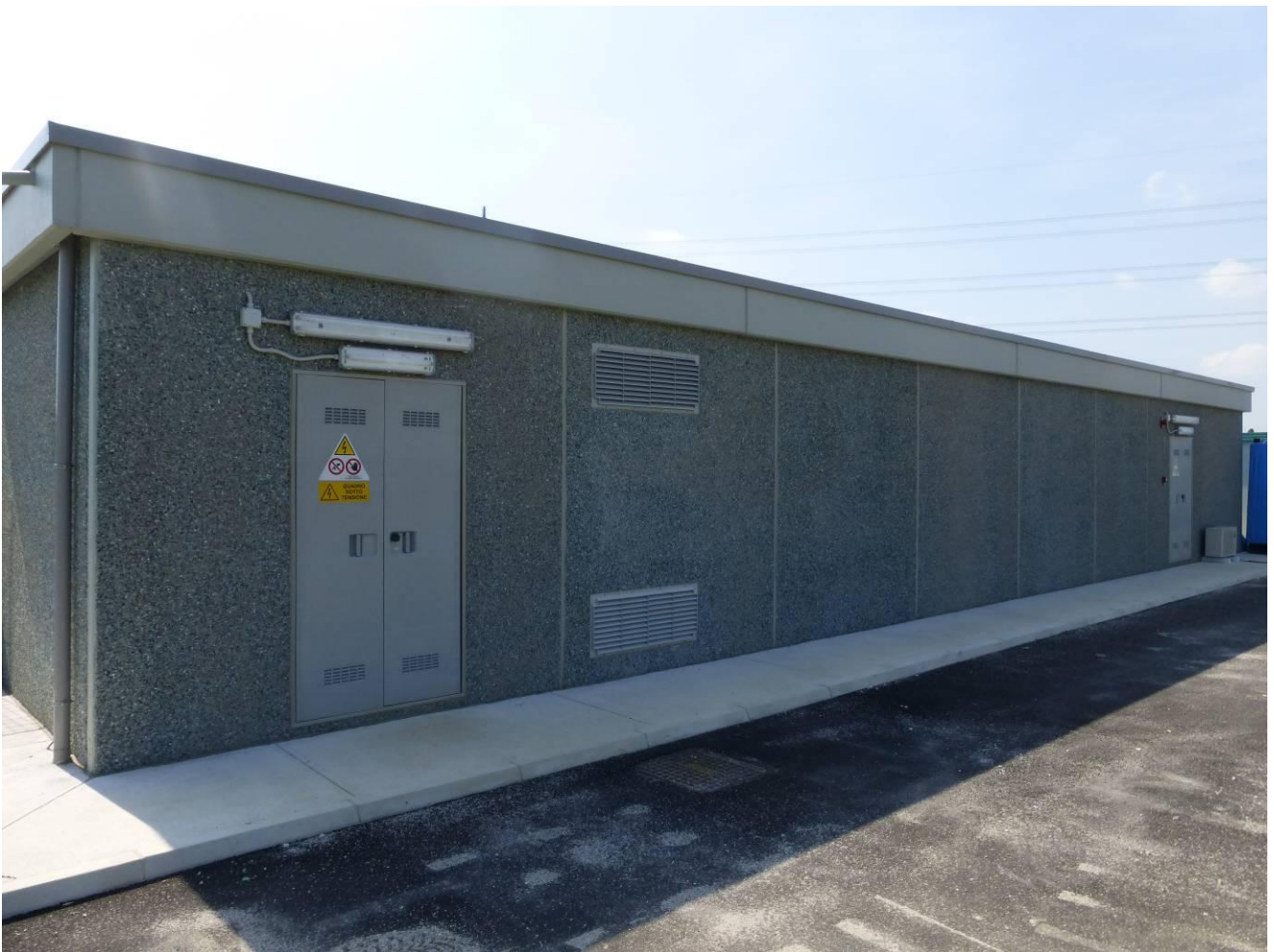
Foto 6 – Vista lato interno alla stazione del fabbricato "P.ti di consegna linee MT e TLC"
