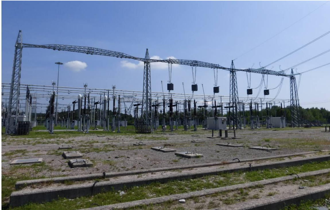
Foto 16 – Portali ingresso linea d.t. 380 kV "S.E. Udine Sud - S.E. Redipuglia"
