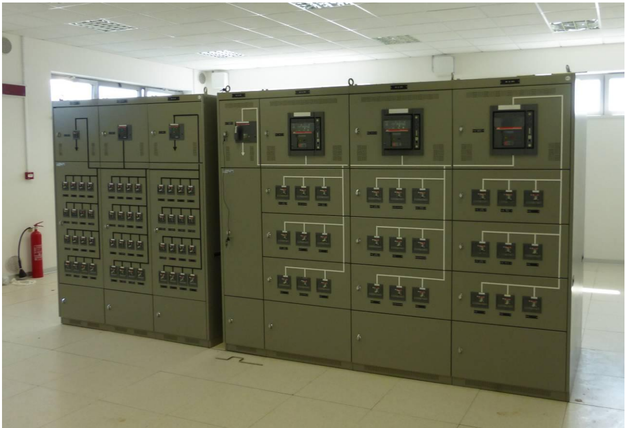
Foto 9 – Quadri centralizzati corrente alternata e corrente continua (interni all'edificio Servizi Ausiliari)
