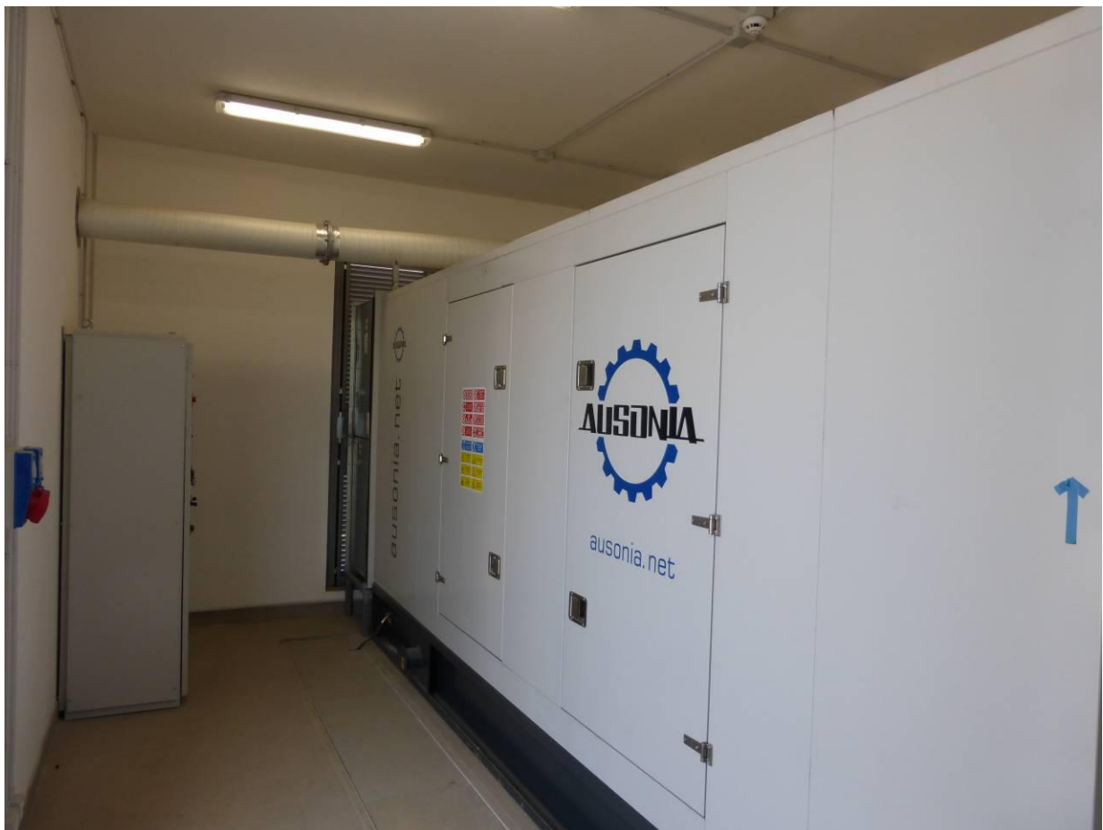
Foto 10 – Gruppo elettrogeno (interno all'edificio Servizi Ausiliari)
