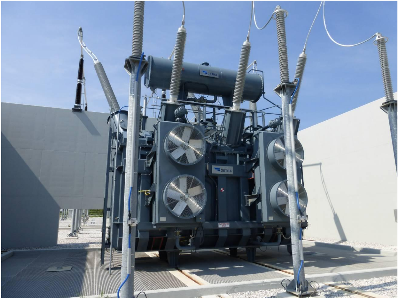
Foto 13 – ATR 400/230 kV da 400 MVA
