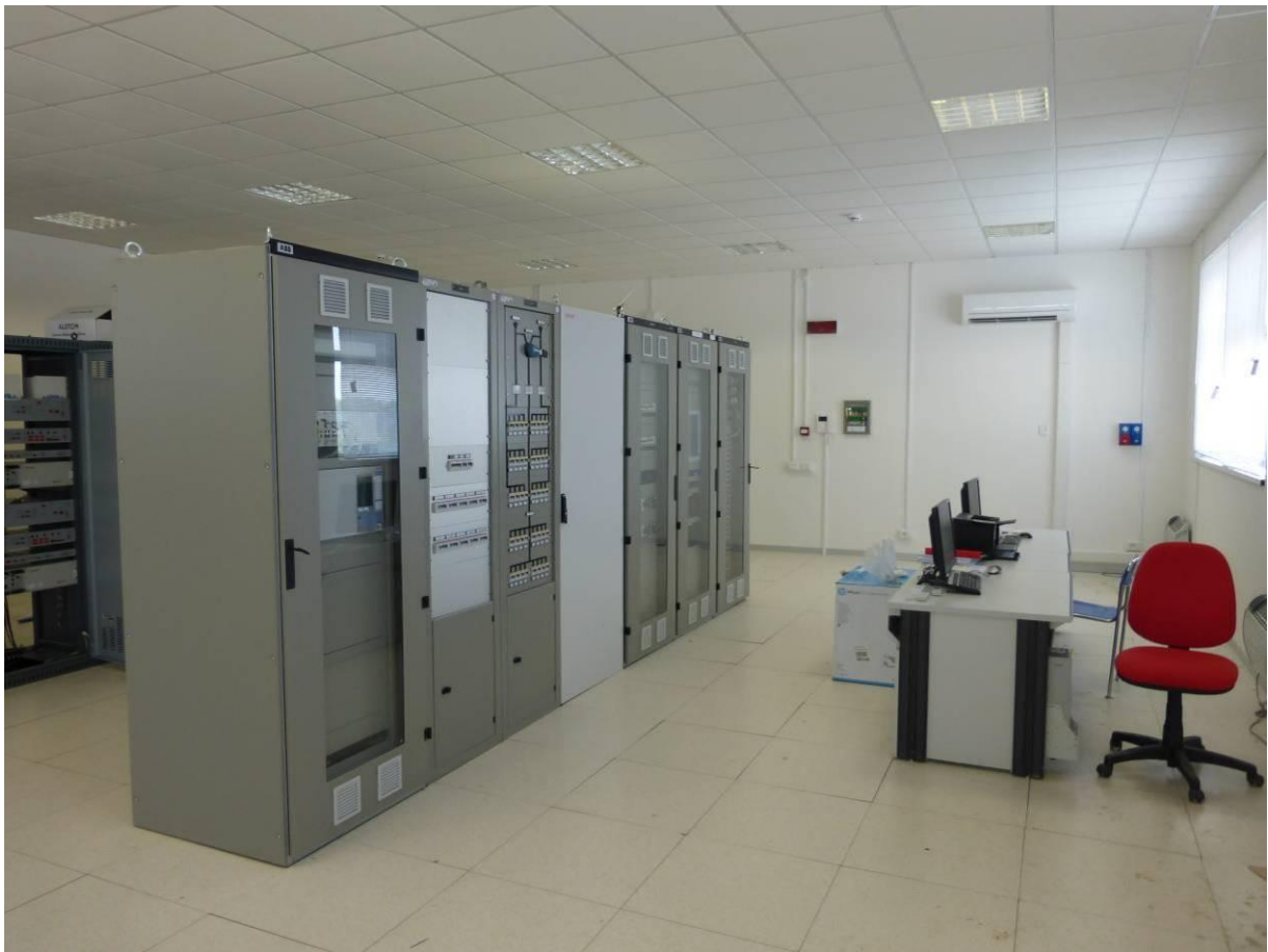
Foto 11 – Quadri SAS centralizzati (interni all'edificio Comandi)
