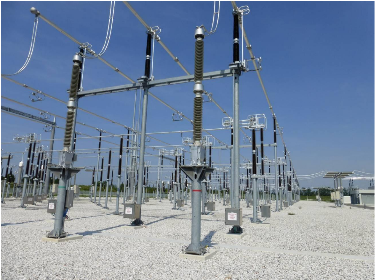
Foto 7 – Sistema a doppia sbarra (sezione 380 kV)
