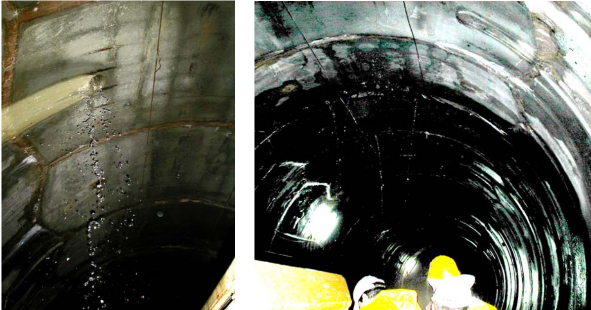
Fig 2: Infiltrazioni d’acqua in galleria dai fori di iniezione e dai conci.
