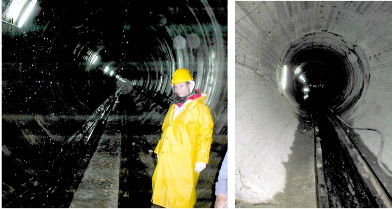
Fig. 3: Le infiltrazioni d’acqua vengono convogliate all’interno dei binari del trenino realizzato per ispezionare la Galleria. Allo sbocco della Galleria è stata effettuata una prova di portata.
