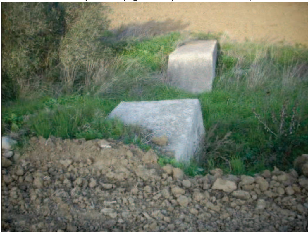
Figura 5.7: Foto rappresentativa dell'alveo attuale del Fosso della Conca poco più a valle del sostegno 222 regimato attraverso una briglia in c.a..
