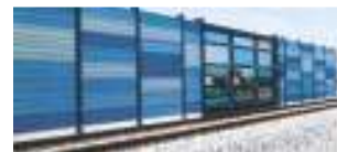
Pannelli a cassetta in alluminio e pannello interno in lana minerale Altezza = 4 metri Lunghezza tratta = 1.500 m
