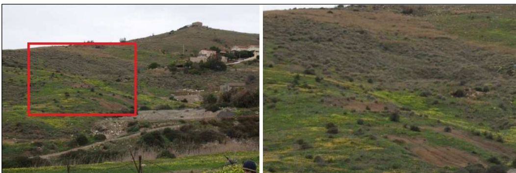
Fig. 21 - Fenomeni franosi presso il tratto di base del versante orientale di quota 132.
