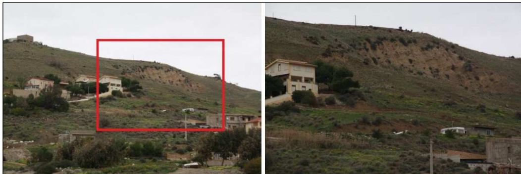
Fig. 20 - Evidenze di zone di potenziali instabilità.
