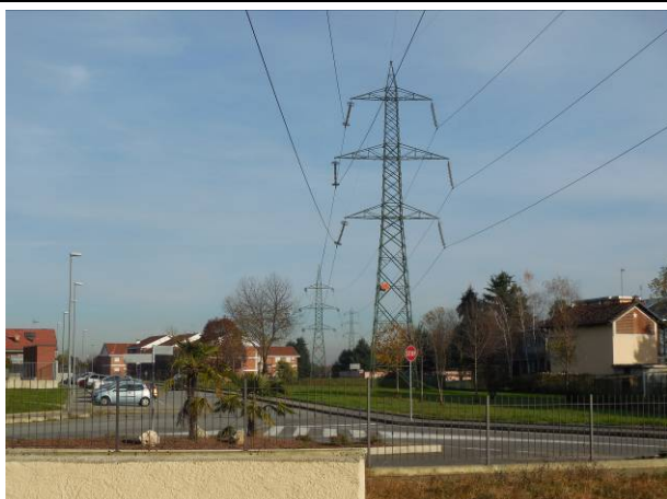
7. In primo piano il sostegno P31, sullo sfondo i sostegni P30 e P.29
