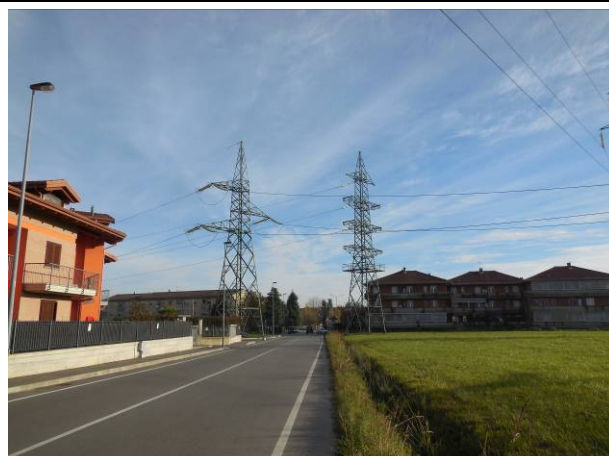
8. Sostegno P32, sulla sinistra, e P32 bis
