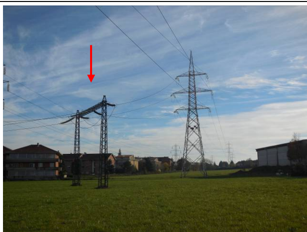
9. Sostegno P33, di raccordo alla linea T.216
