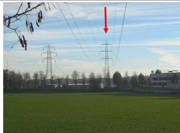
4. Sostegno P138, sulla sinistra la linea T.919-T.920
