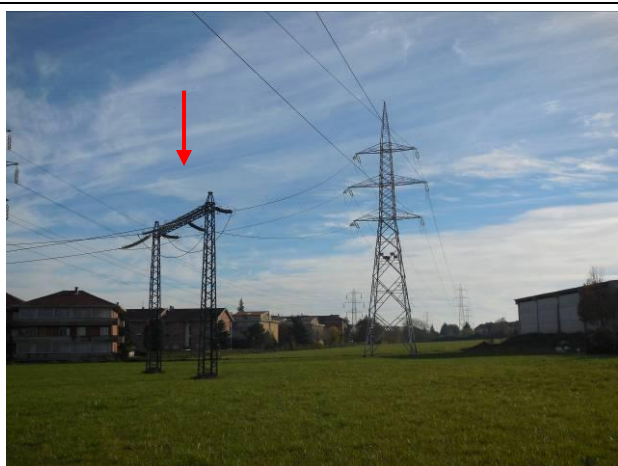
9. Sostegno P33, di raccordo alla linea T.216
