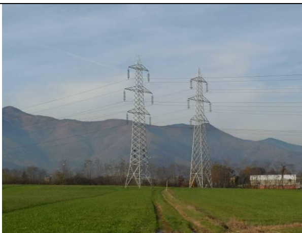
12. Sostegno P14 (P17N-P128N) sulla sinistra, a fianco la linea T.595
