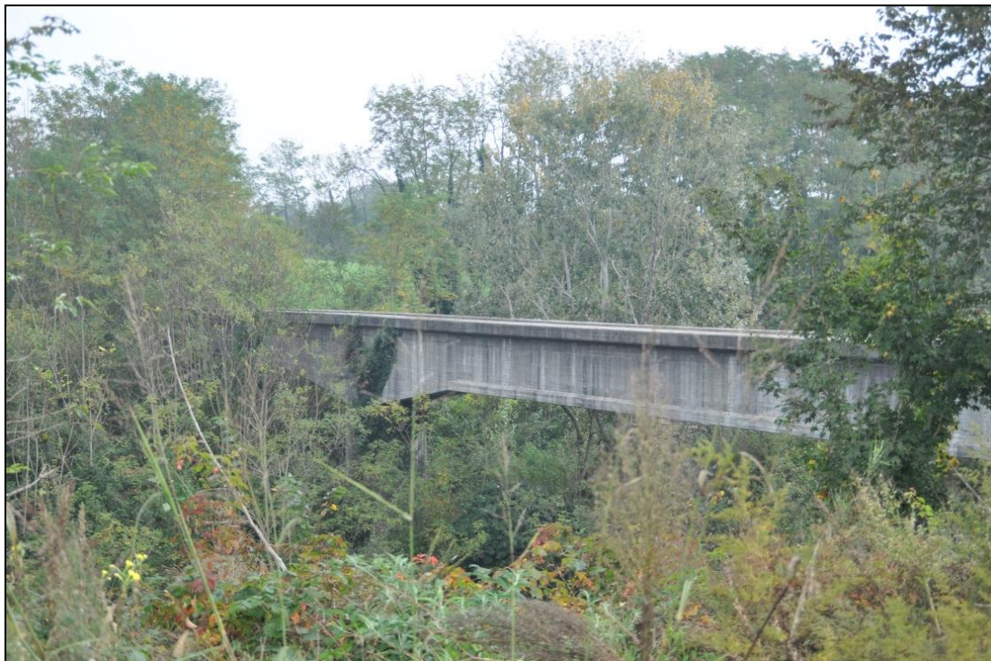
Figura 3.4/6 Il ponte canale a cui vengono staffati i cavi della linea T. 213
