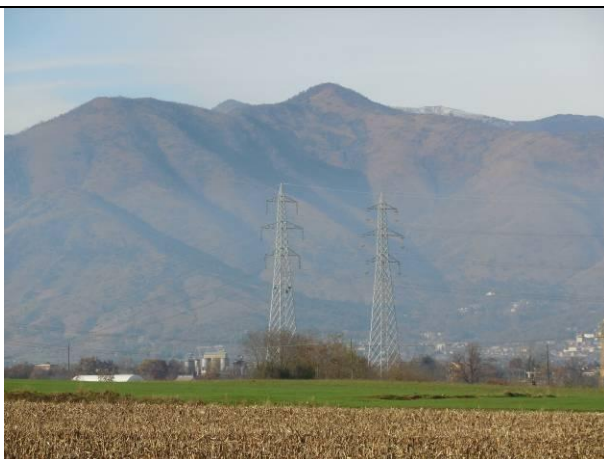
11. Sostegno P13 (P16N-P129N), sulla sinistra, a fianco la linea T.595
