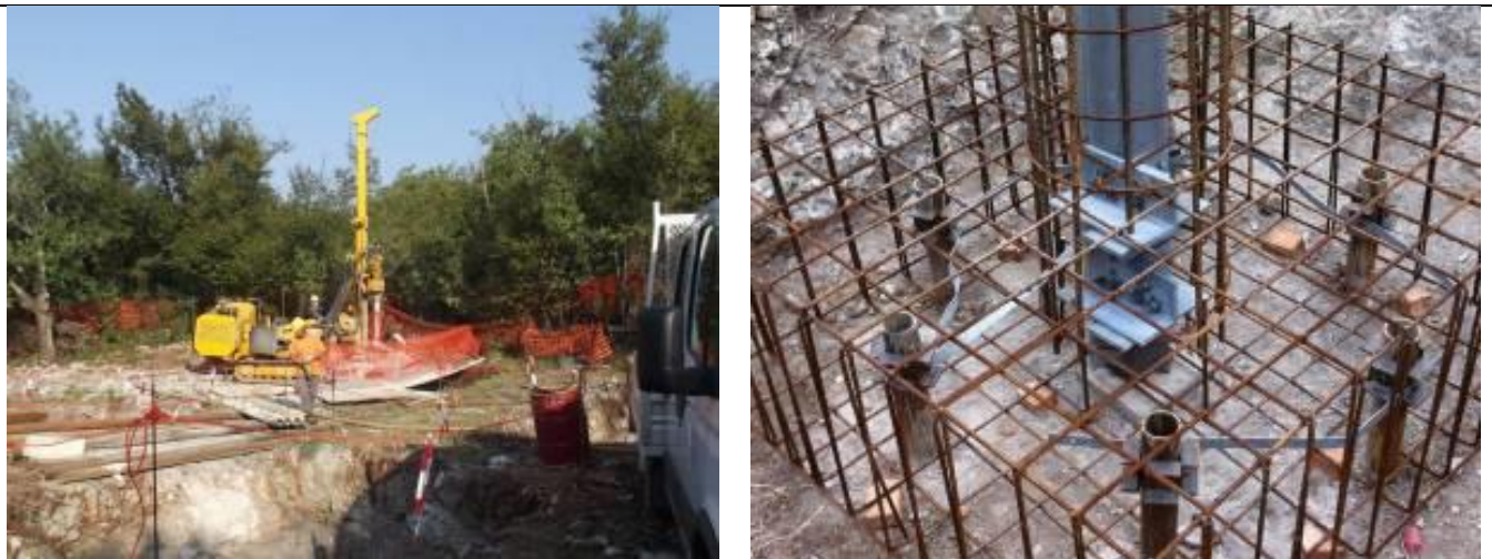
Figura 1.2.2-10 – Esempio di realizzazione di una fondazione su micropali tipo tubfix. Nell'immagine di destra si può notare il particolare del raccordo tra i tubolari metallici dei micropali con l'armatura del plinto di fondazione; al centro del plinto si nota il moncone del sostegno (elemento di raccordo tra il sostegno e la fondazione) il quale viene annegato nella fondazione stessa
