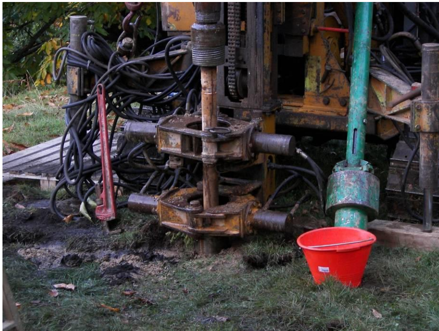
Figura 1.2.2-11 – Macchina operatrice per la realizzazione di micropali tubfix; sistema di scavo a rotopercussione
