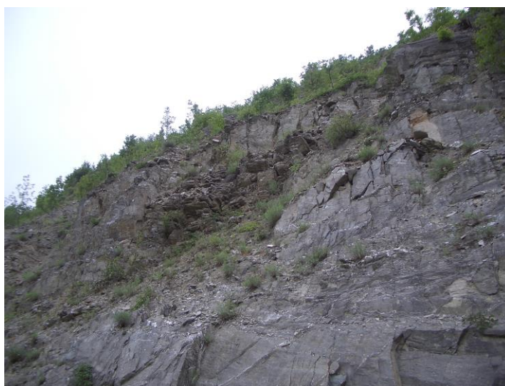
Figura 17: esempio di settore con massi instabili (n 25).
