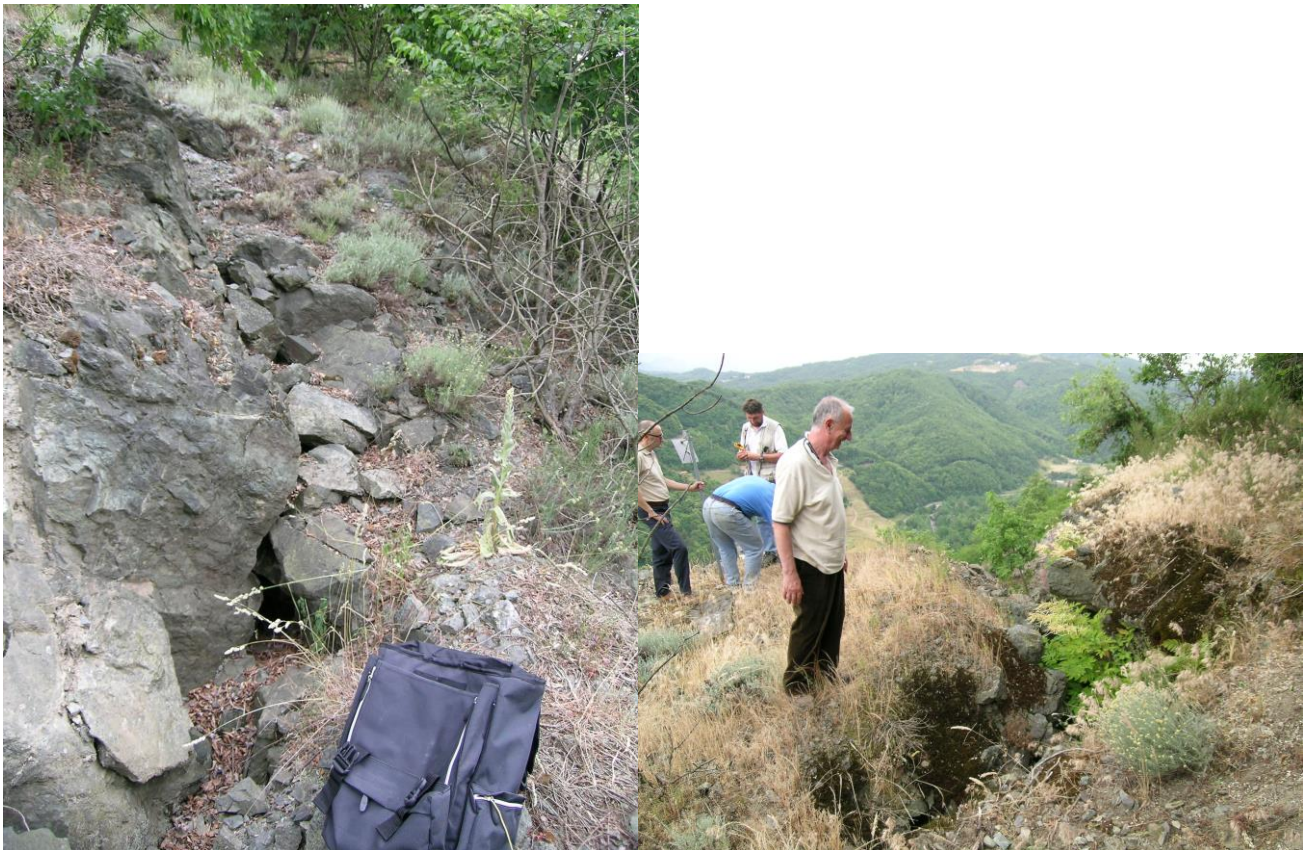
5-6- Sopra il coronamento di frana e a sud dello stesso vi sono numerosi avvallamenti e trincee che evidenziano un marcato detensionamento del versante impostato su meta basalti. Nella foto in sinistra la fenditura è visibile tra la
