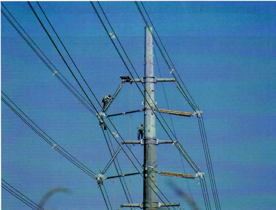
Foto 3 sostegno n. 39 personale all'opera per la rimozione delle protezioni degli isolatori il 29/08/15
