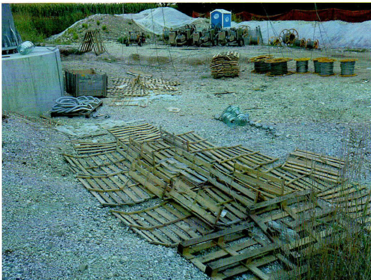
Foto n. 7 sostegno n. 43 tutti gli isolatori temprati fissati il 07/08/15
