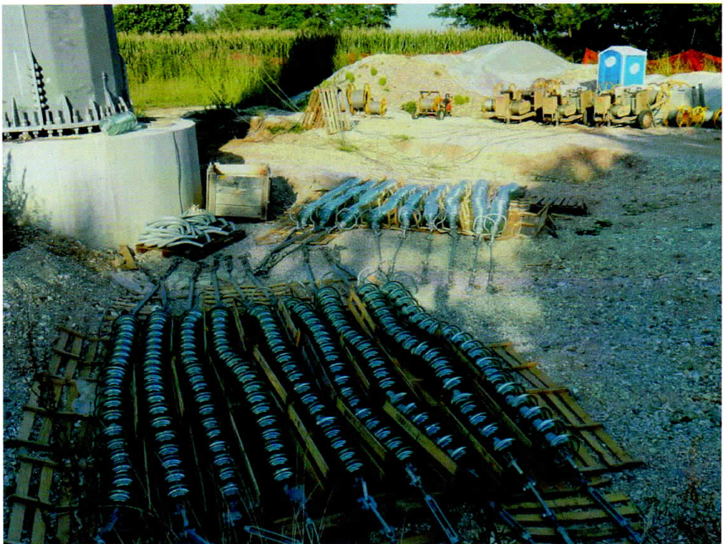
Foto 3 sostegno n. 43 isolatori temprati pronti per il fissaggio il 04/08/15
