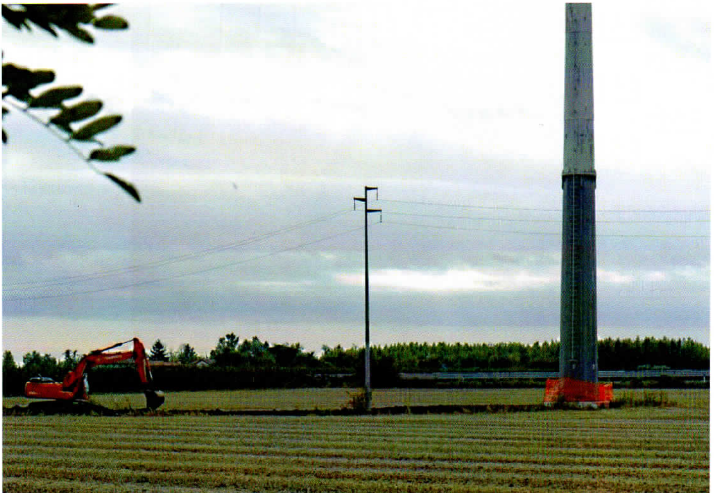
Foto 5 sostegno n. 48 escavatore in fase di chiusura della strada di accesso al cantiere il 12/10/15
