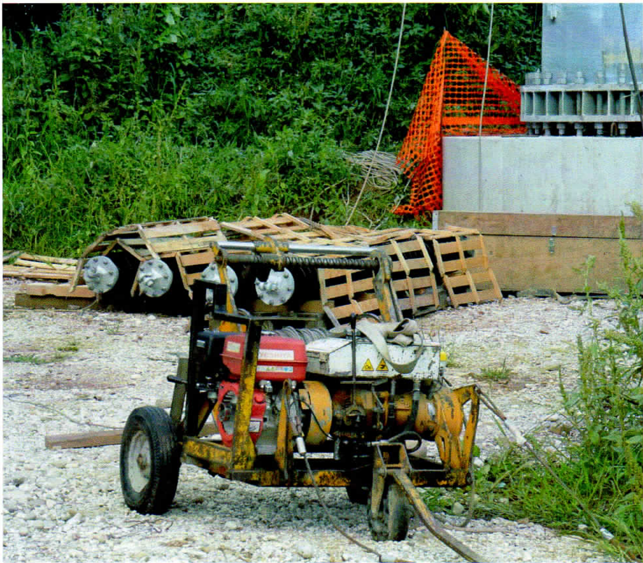
Foto 3 sostegno n. 32 con alla base il cantiere e i restanti distanziali da imbullonare il 17/08/15
