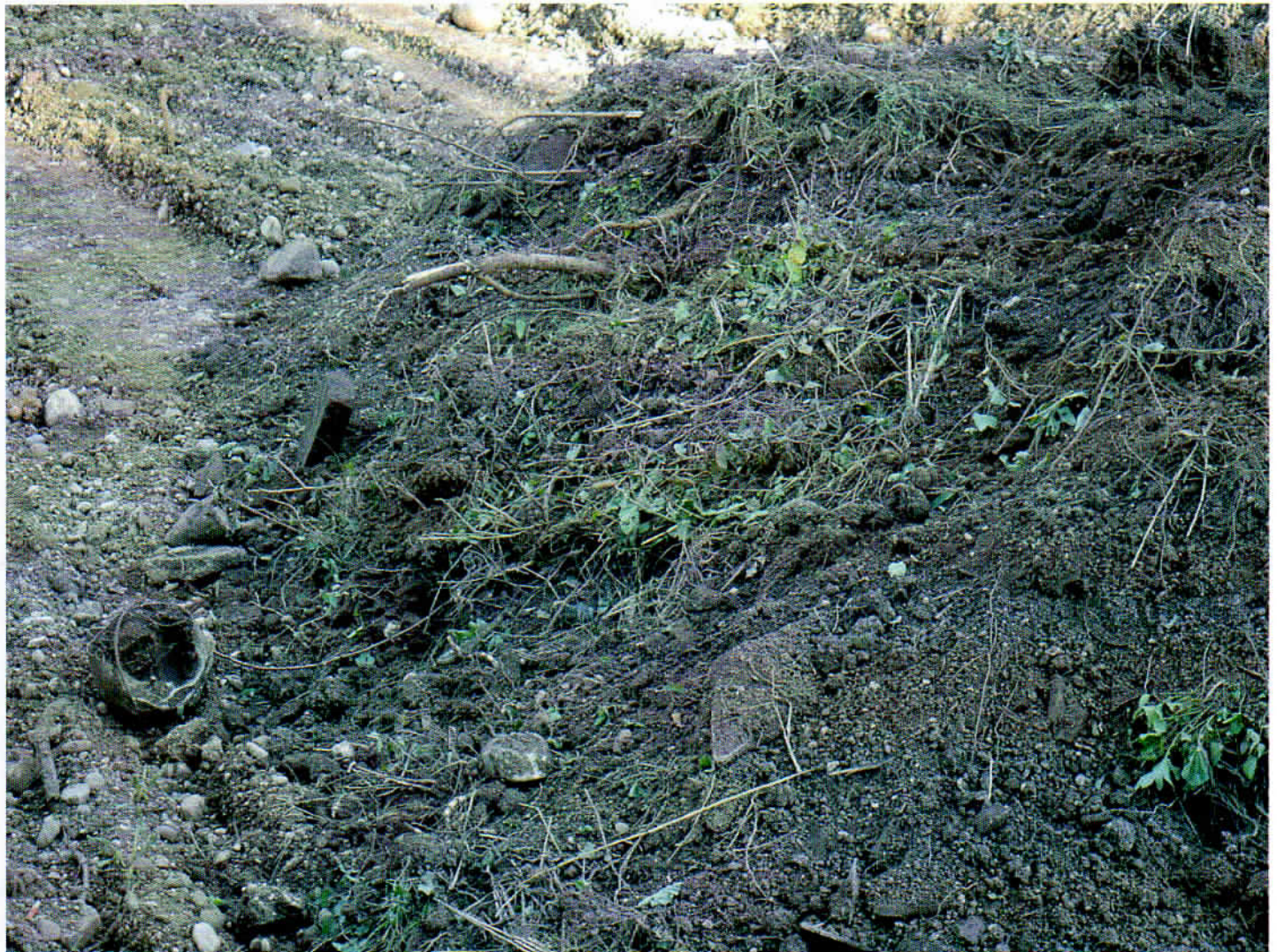
Foto 7 sostegno n. 36 primo carico di materiale di provenienza dubbia per il completamento del ritombamento il 08/10/15
