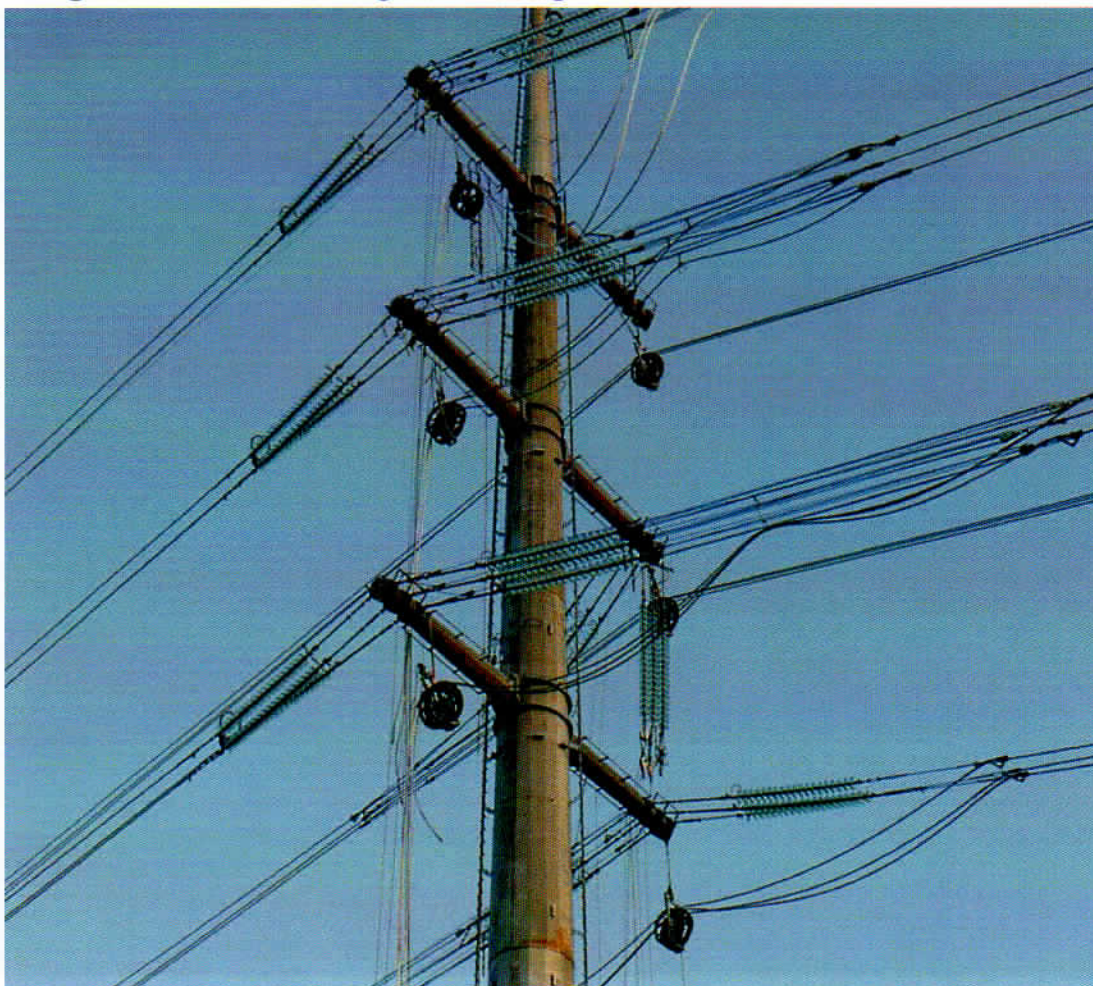
Foto 5 alcuni giorni dopo sempre sul sostegno n. 43 il 06/08/15
