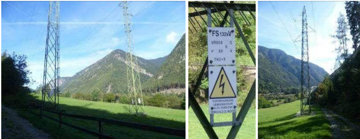
Abbildung 85 – Bestehende Elektr. Freileitungen
