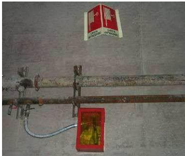
Abbildung 122 - Hydranten im Tunnel
