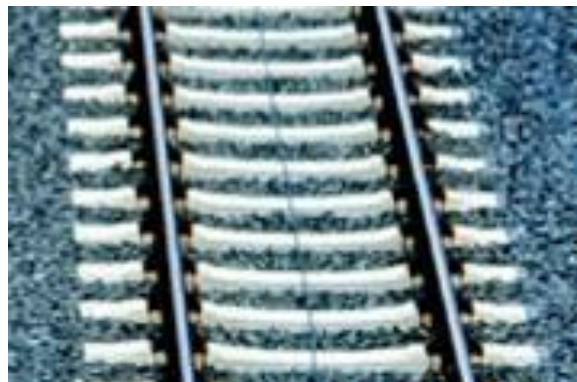
Illustrazione 34 - Armamento ferroviario
