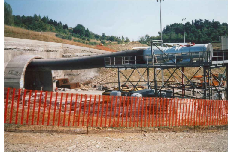
Ventilatore assiale montato su struttura metallica a traliccio
