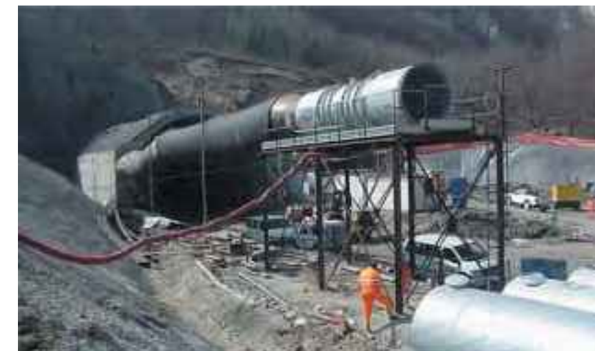
Tubazione di tipo flessibile per il trasporto dell'aria esterna al fronte di scavo, realizzata con supporto di base in poliestere a grammatura medio-alta plastificato su unetambre in Superfic, impuntucabile. La tubazione viene progressivamente allungata con l'avanzamento dei lavori.
