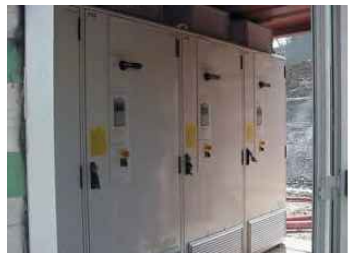
Sistema di regolazione a Inverter, alimentazione elettrica sotto linea normale o privilegiata.
