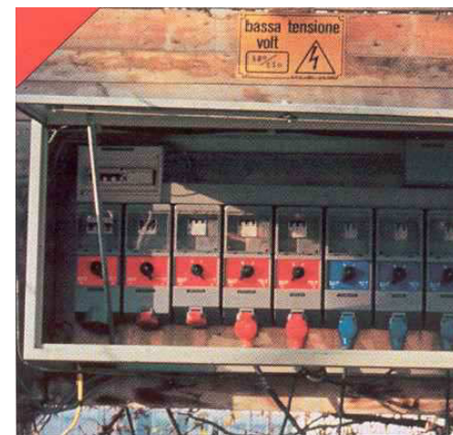
QUADRO ELETTRICO DI CANTIERE HAUPTSCHALTFAEL EINER BAUSTELLE.
