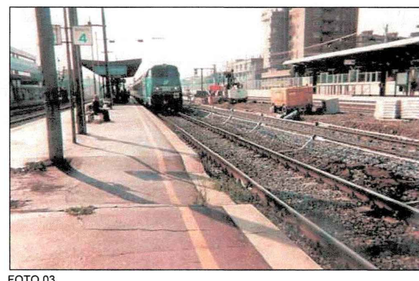
FOTO 03 Esempio di un cantiere operativo in presenza di barriera di protezione e circolazione treni sul binario affiancato
