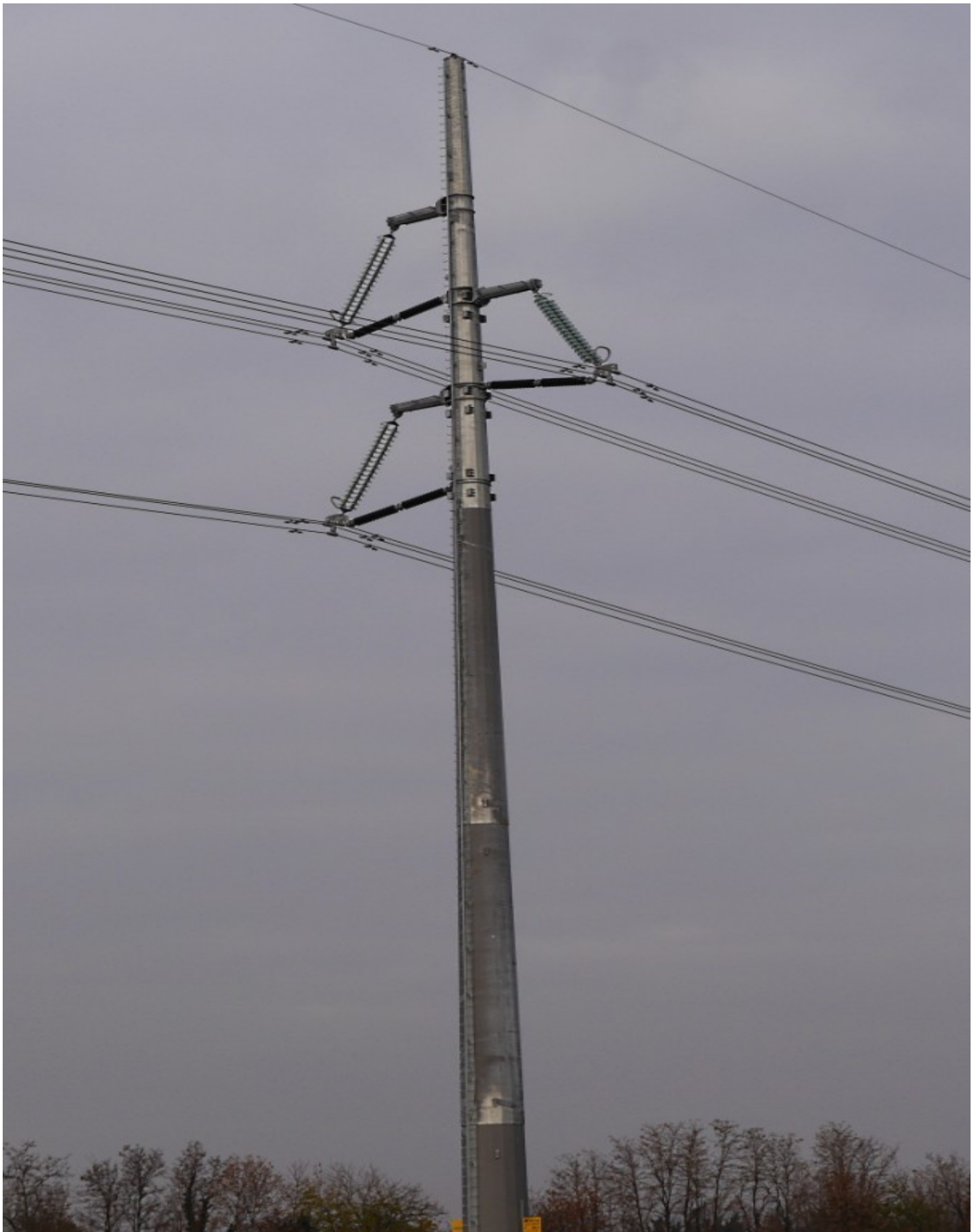
Foto 6 sostegno n. 56bis in esercizio a Basiliano il 15/12/15 (variante Udine ovest-Planais a 380 kV ST) con armamento a mensole isolanti e smorzatori di vibrazioni installati.
