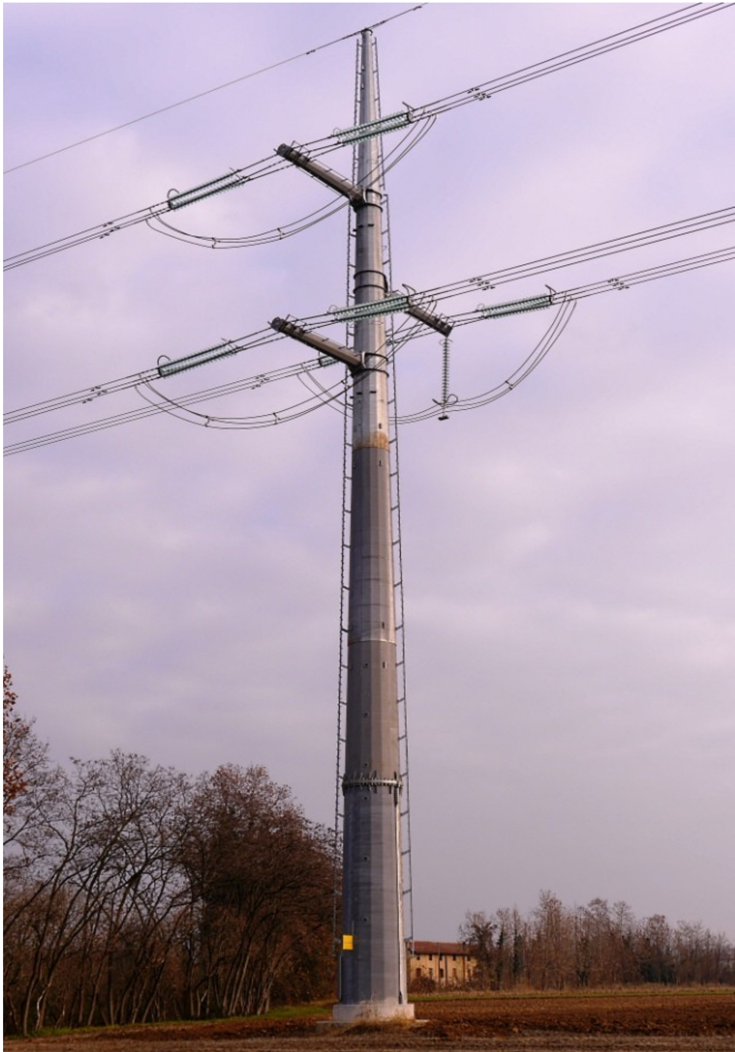
Foto 4 sostegno n. 57a angolare in esercizio a Basiliano il 15/12/15 (variante Udine ovest-Planais a 380 kV ST) armamento di amarro
