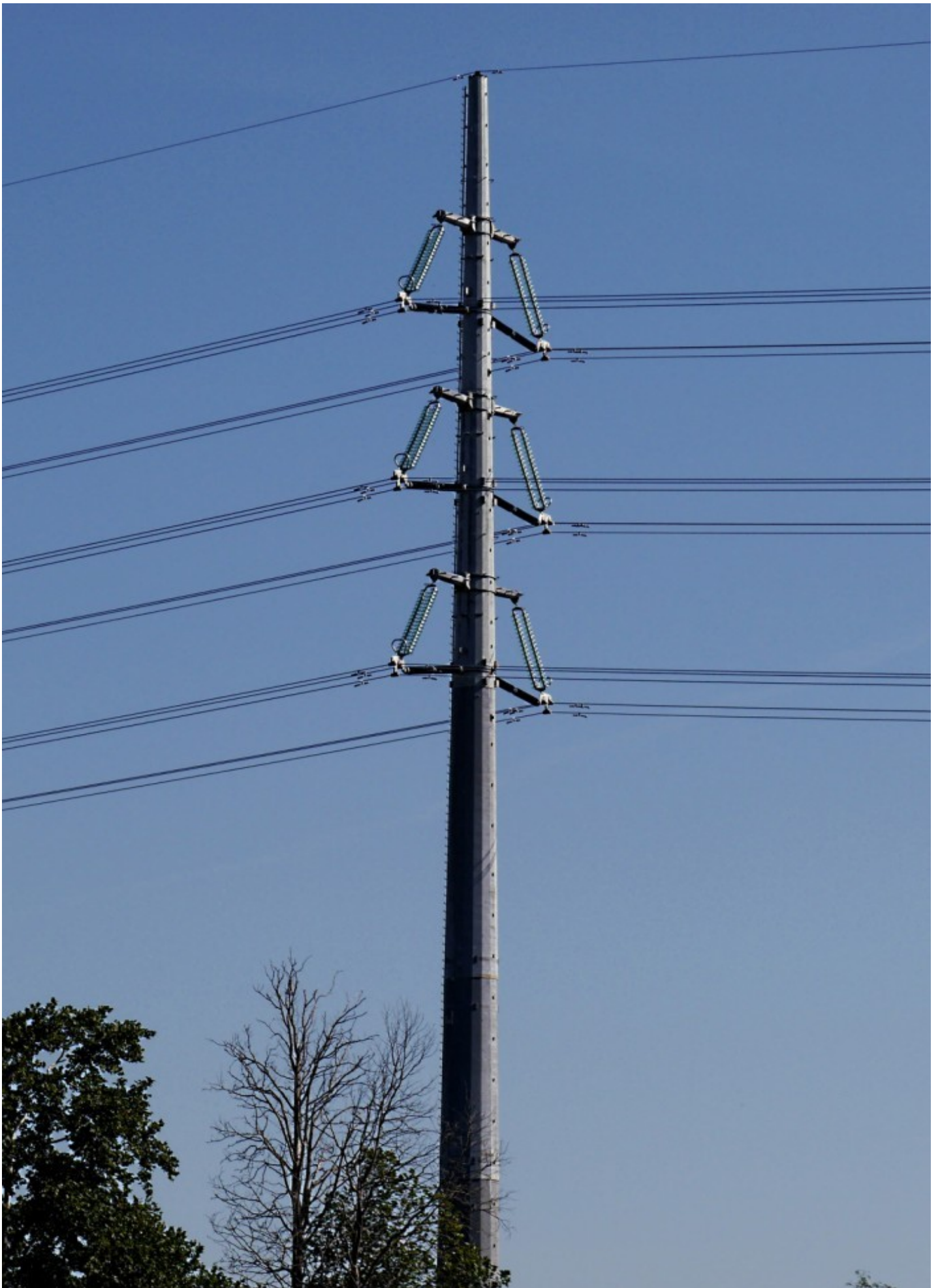
Foto 7 sostegno n. 38 con geometria dell'armamento a mensole isolanti composto da un puntone rigido e da un tirante (ambidue singoli o doppi) e smorzatori di vibrazioni installati.
