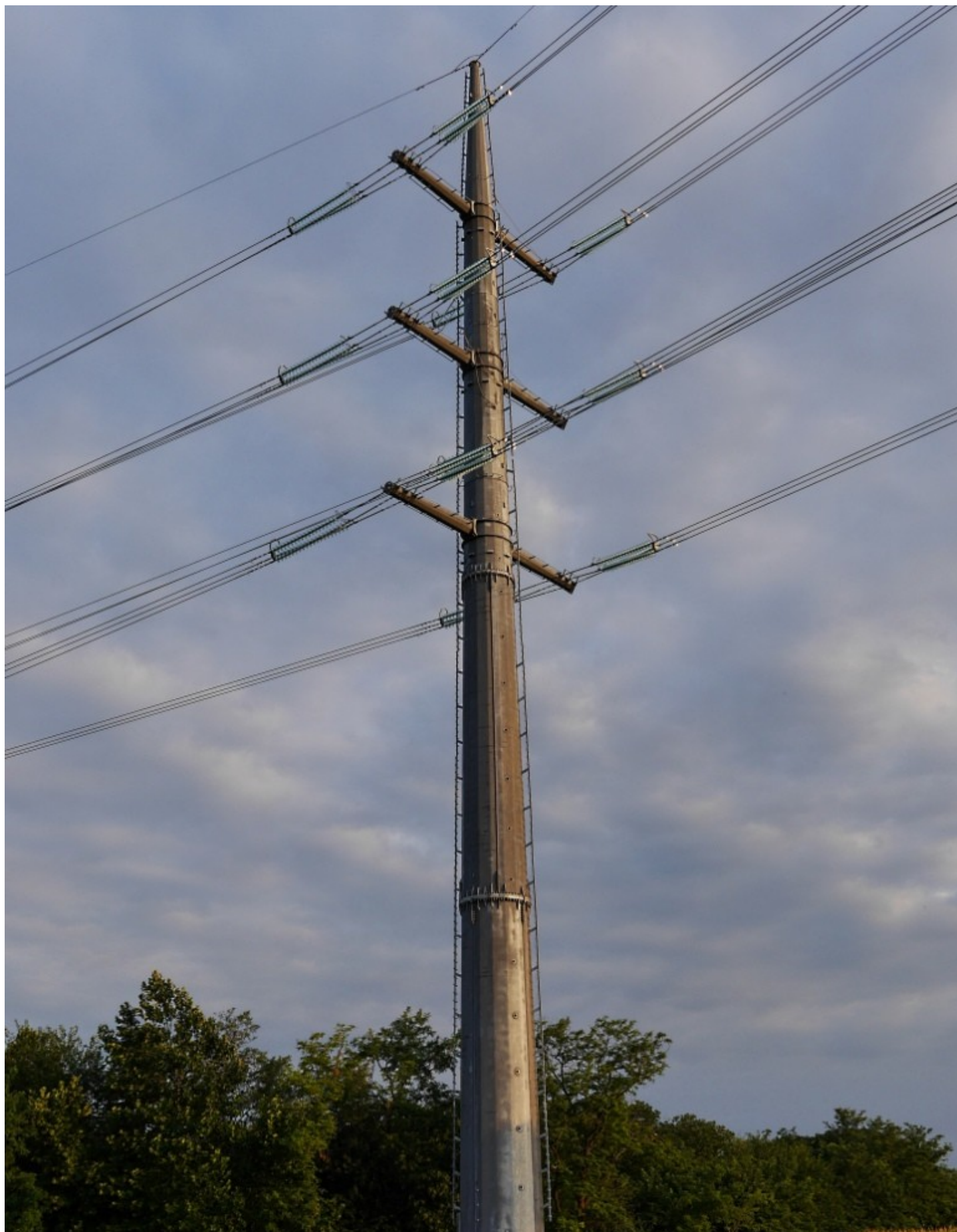
Foto 3 sostegno n. 36 con armamento di amarro completo con ancoraggio dei conduttori alla struttura.
