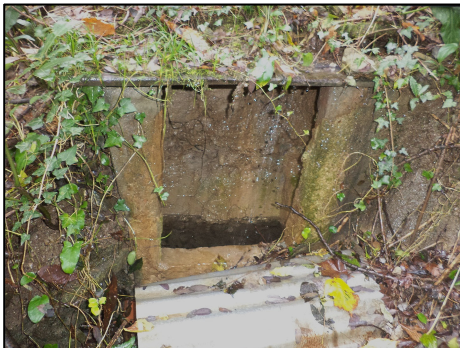
Foto 6.4 – Sorgente S-CE-307 in occasione del rilievo effettuato nella campagna Gen-Mar '15. Da notare la filtrazione dell'acqua che avviene attraverso le pareti del bottino.
